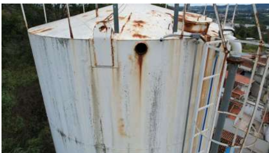
Foto 1 - Detalhe do extravasor sem rede de proteção contra entrada de insetos e pequenos animais.
