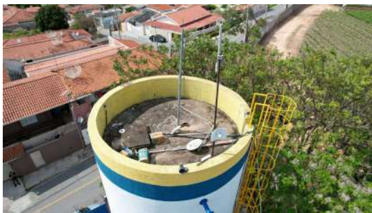
Foto 1 - Detalhe da haste do para-raios.
