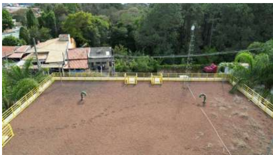
Foto 5 - Detalhe da superfície do reservatório.
