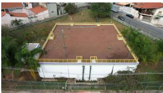
Foto 1 - Hastes de para-raio em cada canto do reservatório.
