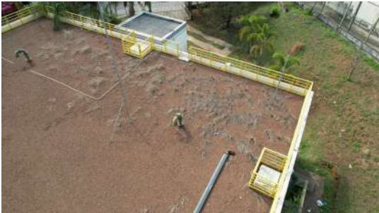
Foto 1 - Detalhe da tubulação de ventilação.
