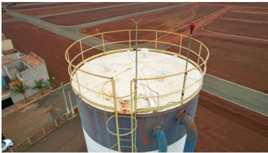
Foto 1 - Para-raios do Reservatório Elevado Santa Carolina em Leme
