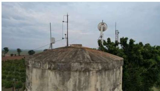
Foto 2 - Para-raios do Reservatório Elevado Taquari Bairro em Leme
