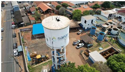
Foto 2 - Reservatório Elevado da ETA II, com ave sobre passagem de inspeção com ausência de tampa
