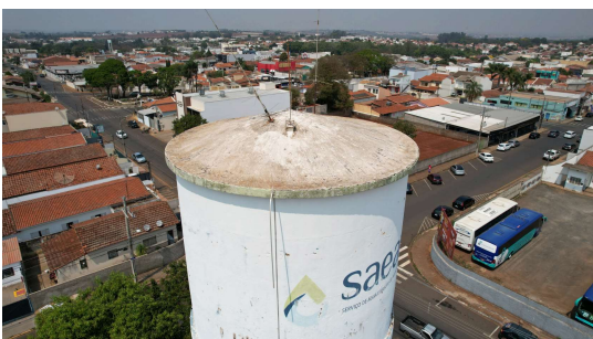
Foto 1 - Fio de aterramento do para-raios rompido
