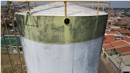
Foto 1 - Detalhe da tubulação de ventilação sem telas de proteção contra entrada de insetos e pequenos animais
