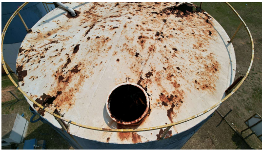
Foto 1 - Ausência de tampa na passagem de inspeção de um dos reservatórios
