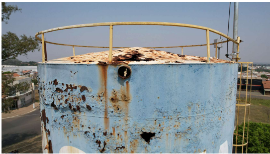
Foto 1 - Parte superior e lateral de um dos reservatórios com estágio avançado de corrosão
