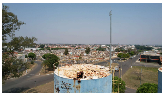
Foto 2 - Detalhes do estado de corrosão do corpo metálico do reservatório
