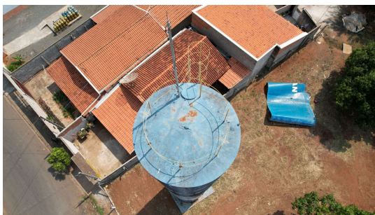
Foto 1 - Vista aérea do Reservatório Itamaraty com fio de descida do para-raios rompido
