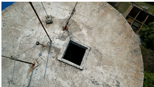
Foto 1 - Ausência de tampa sobre a passagem de inspeção do reservatório da ETA II
