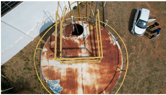
Foto 1 - Ausência de tampa de inspeção no Reservatório Martinelli
