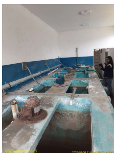
Foto 9 - Tanques de preparação de Sulfato de Alumínio e carbonato de sódio
