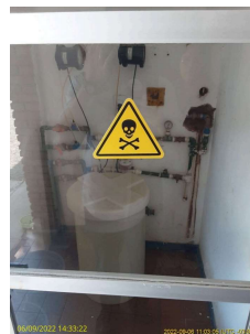
Foto 8 - Dosadora de hipoclorito de sódio da ETA Monte Alegre
