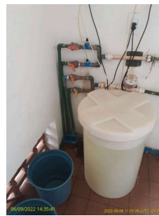
Foto 2 - Vazamento no tambor de Hipoclorito de sódio
