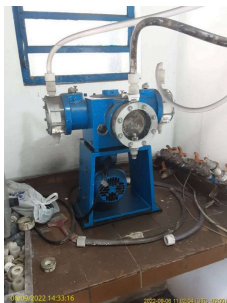
Foto 7 - Dosadora de carbonato de sódio da ETA Monte Alegre
