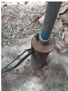
Foto 1 - Tubo de medição da Captação subterrânea Ponte Preta em Monte Alegre do Sul
