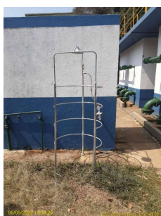
Foto 1 - Chuveiro de emergência da ETA Monte Alegre
