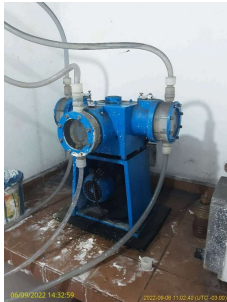
Foto 5 - Dosadora de carbonato de sódio da ETA Monte Alegre
