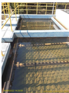
Foto 13 - Decantadores da ETA Monte Alegre
