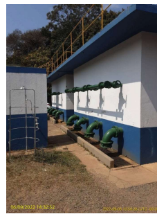
Foto 4 - Vista do chuveiro de emergência e tubulações da ETA Monte Alegre
