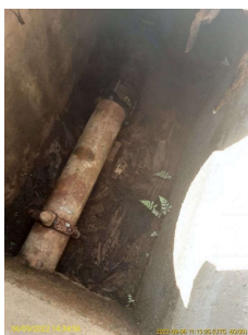
Foto 1 - Macromedidor saída da ETA Monte Alegre
