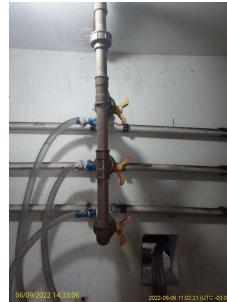
Foto 6 - Tubulações de dosagem de hipoclorito de sódio da ETA Monte Alegre
