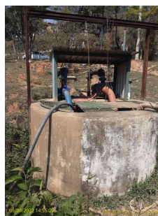
Foto 8 - Bombas de captação do Ribeirão Monte Alegre
