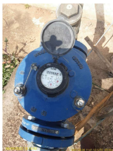
Foto 1 - Macromedidor do Poço do Bairro das Mostardas
