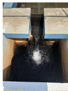
Foto 12 - Saída da água após decantação da ETA Monte Alegre
