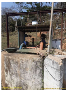
Foto 7 - Bombas de captação do Ribeirão Monte Alegre
