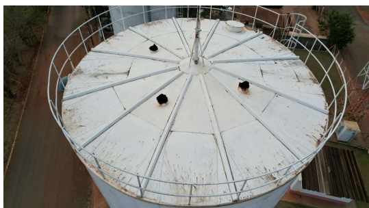
Foto 1 - Detalhe das três aberturas sem cobertura/proteção no RES. ELEVADO 2.
