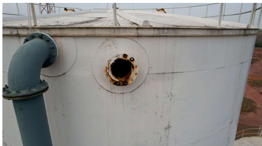
Foto 1 - Detalhe da ausência de tela de proteção na tubulação.
