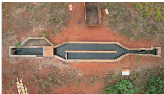
Foto 4 - Vista superior da calha Parshall na chegada da ETE.
