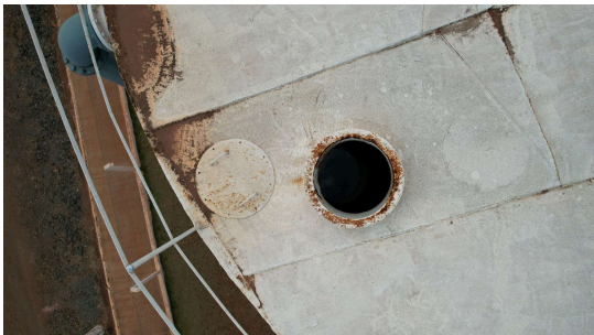
Foto 1 - Detalhe da tampa de inspeção aberta.
