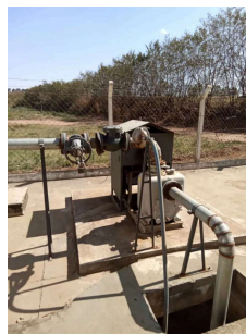
Foto 2 - Conjunto motobomba instalado e em funcionamento.
