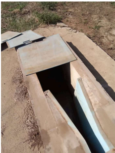
Foto 15 - Calha parshall na entrada da ETE
