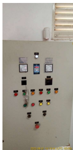
Foto 1 - Painel de comando da bomba (apenas uma instalada).
