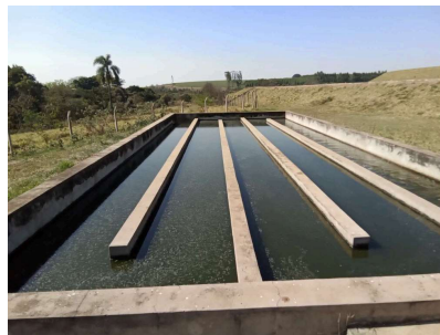
Foto 4 - Chicanas situadas após a calha parshall
