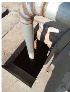
Foto 3 - Poço de sucção.
