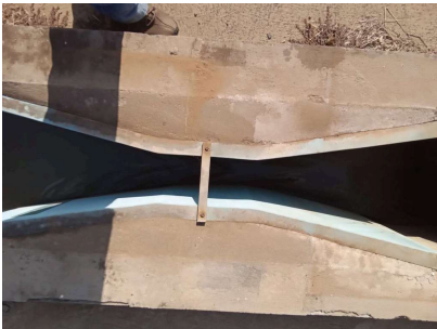
Foto 16 - Calha parshall na entrada da ETE
