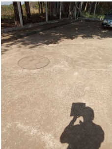
Foto 2 - Poço pulmão da elevatória.
