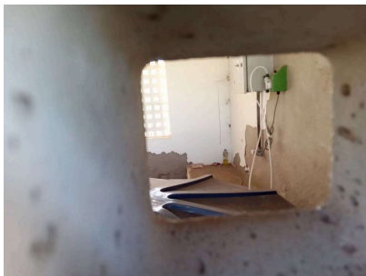
Foto 6 - Abrigo para armazenamento de hipoclorito de sódio, aplicado e dosado na calha Parshall de saída da ETE.
