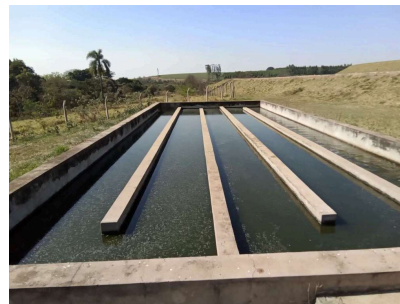
Foto 7 - Chicanas na saída da ETE, a jusante das lagoas e antes do lançamento.
