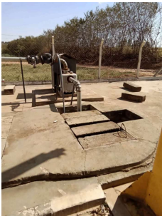
Foto 1 - Bomba a seco, externa ao poço de sucção.
