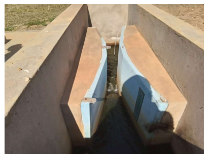
Foto 3 - Aplicação e dosagem de cloro na calha parshall da saída da ETE.
