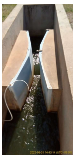
Foto 1 - Calha parshall na saída da ETE.
