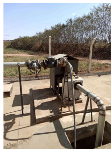
Foto 2 - Conjunto motobomba instalado e em funcionamento.
