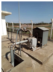
Foto 2 - A manutenção no conjunto motobomba pode ser realizada externamente.
