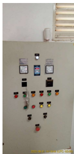
Foto 1 - Painel de comando da bomba (apenas uma instalada).
