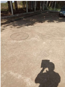
Foto 2 - Poço pulmão da elevatória.
