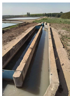
Foto 10 - Entrada do efluente bruto na ETE
