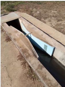
Foto 13 - Calha parshall na entrada do efluente.
