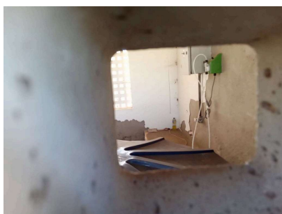
Foto 1 - Armazenamento de hipoclorito de sódio para dosagem na saída da ETE.
