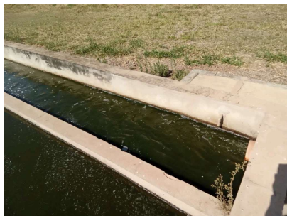
Foto 5 - Entrada do efluente tratado na chicana, após a calha parshall.
