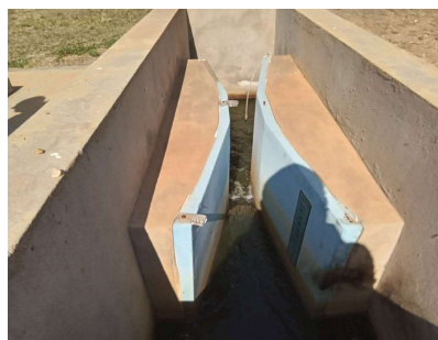
Foto 2 - Calha parshall na saída da ETE.
