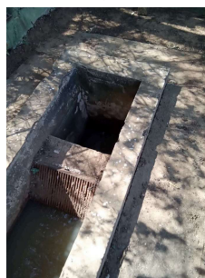
Foto 5 - Gradeamento grosso à montante da ETE.
