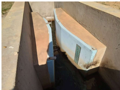
Foto 3 - Calha parshall na saída da ETE.
