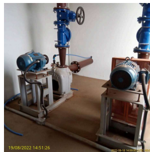
Foto 4 - Conjuntos motobombas da elevatória de esgoto
