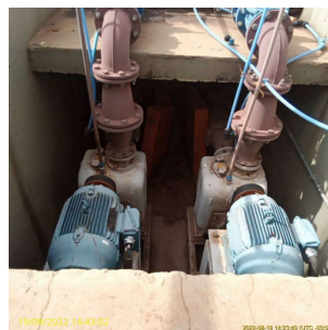
Foto 2 - Conjuntos motobombas da EEE Jardim Apolo
