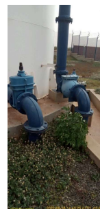
Foto 5 - Tubo extravasor do Reservatório Pacaembu
