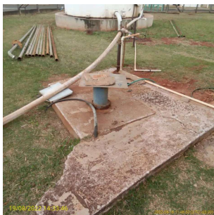
Foto 1 - Vista interna do Poço Distrito Industrial
