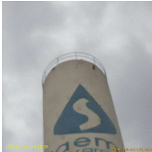
Foto 1 - Pontos com marcas de oxidação na parte superior e no guarda-corpo do Reservatório Residencial Lagoa
