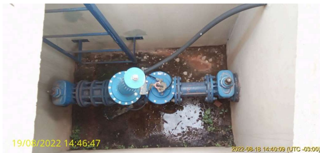
Foto 4 - Válvula reguladora de pressão do Reservatório Pacaembu
