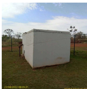
Foto 2 - Poço de sucção da EEE Residencial Lagoa
