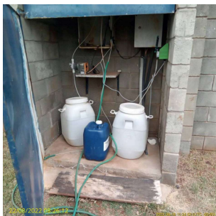
Foto 4 - Armazenamento e dosagem de produtos químicos para cloração e fluoretação.
