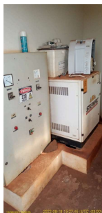
Foto 3 - Painel elétrico da EEE Orquídea
