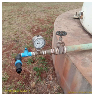
Foto 2 - Manômetro do Reservatório Distrito Industrial
