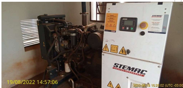
Foto 4 - Gerador da EEE Orquídea
