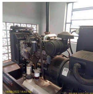
Foto 4 - Gerador da EEE Jardim Apolo
