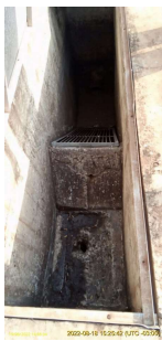
Foto 1 - Gradeamento da ETE Orquídea
