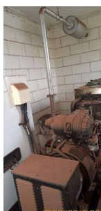
Foto 5 - Gerador EEE Residencial Lagoa (inoperante)
