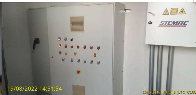
Foto 8 - Pannel de comando e controle da ETE Pacaembu
