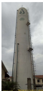
Foto 1 - Reservatório Res. Arn. Mazon
