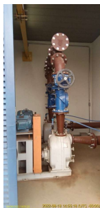
Foto 3 - Estação elevatória de esgoto no interior da ETE Pacaembu
