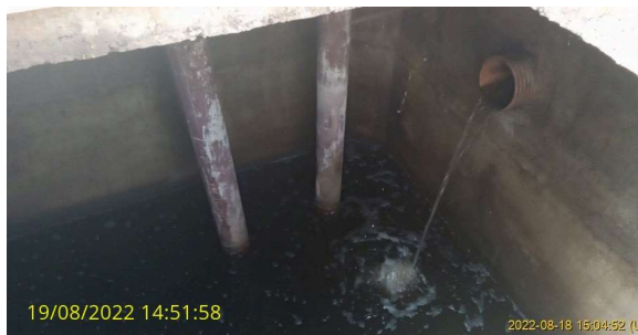
Foto 9 - Poço de sucção da ETE Pacaembu
