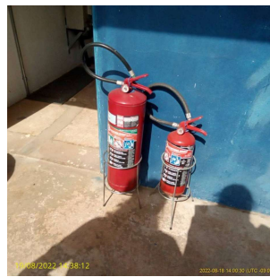
Foto 4 - Extintor de incêndio
