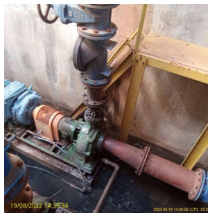
Foto 2 - Existência de vazamentos nas bombas da EEE Zona Norte
