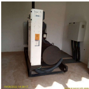
Foto 5 - Gerador da EEE Zona Norte
