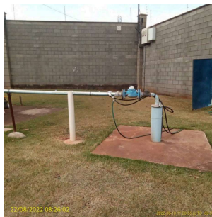
Foto 2 - Cavelete do Poço Residencial Lagoa
