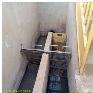
Foto 1 - Gradeamento da ETE Pacaembu
