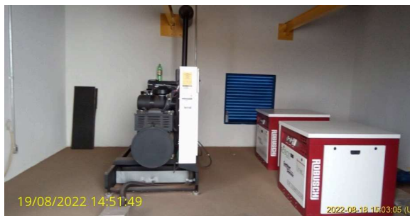
Foto 7 - Vista do gerador e dos sopradores da ETE Pacaembu
