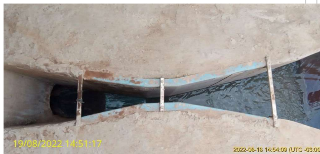
Foto 2 - Calha Parshall da ETE Pacaembu
