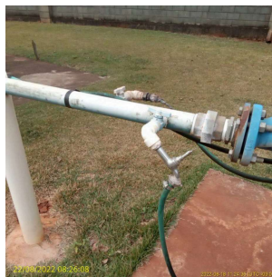
Foto 3 - Tomada de água do Poço Residencial Lagoa
