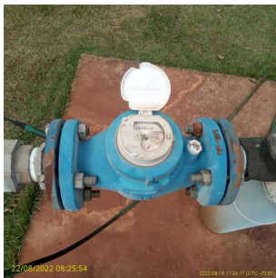
Foto 1 - Macromedidor do Poço Residencial Lagoa
