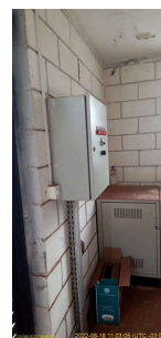
Foto 4 - Painel elétrico da EEE Residencial Lagoa
