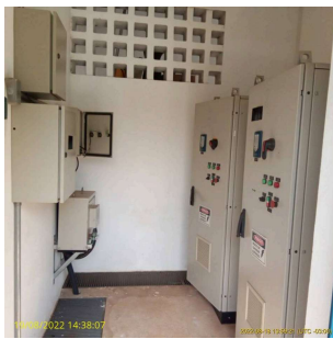
Foto 3 - Vista da cabine dos painéis elétricos
