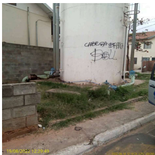
Foto 1 - Ausência de cercamento do Reservatório Res. Arnaldo Mazon
