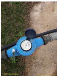
Foto 1 - Macromedidor do Poço 29
