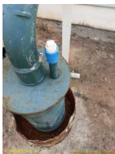
Foto 1 - Tubo de medição de nível do Poço 30 - Jatobá
