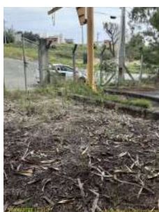
Foto 1 - Detalhe da vegetação crescendo dentro da área da EEE.
