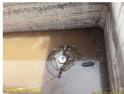
Foto 6 - Detalhe do aerador.
