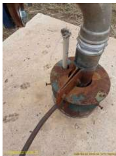
Foto 1 - Tubo de medição de nível do Poço 21
