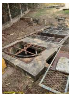
Foto 2 - Vista geral da elevatória sem gradeamento.
