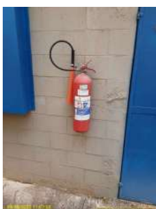
Foto 1 - Extintor de incêndio próximo à elevatória.
