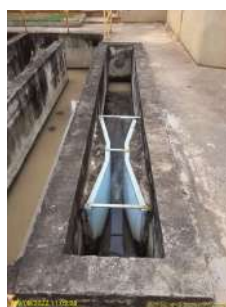
Foto 7 - Calha Parshall na saída do efluente tratado.
