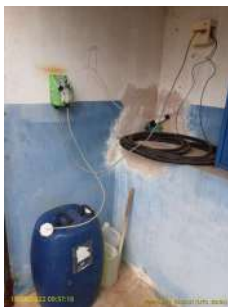
Foto 1 - Sistema dosador de cloro do Poço 21
