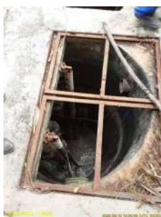
Foto 1 - Detalhe da ausência de grades nas elevatórias da chegada do esgoto bruto.
