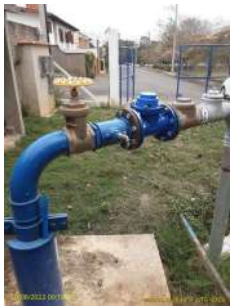
Foto 1 - Ponto de tomada de água para coleta de água bruta
