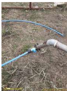
Foto 1 - Tomada de água para coleta de água bruta do Poço 21
