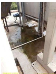
Foto 1 - Vazamento no piso superior da ETE.
