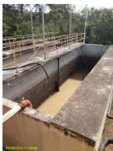
Foto 3 - Detalhe do tanque principal.
