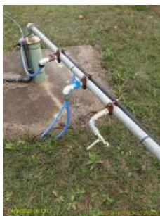
Foto 1 - Tomada de água para coleta de água bruta do Poço 29
