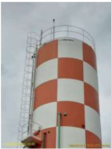
Foto 1 - Para-raios no topo do Reservatório Jatobá
