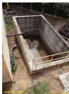
Foto 4 - Detalhe do tanque auxiliar.
