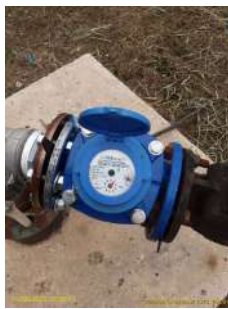
Foto 1 - Macromedidor do Poço 21
