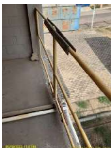
Foto 1 - Detalhe do guarda-corpo com improvisação para fixação das barras metálicas.
