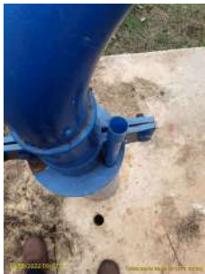
Foto 1 - Tubo de medição de nível do Poço 32
