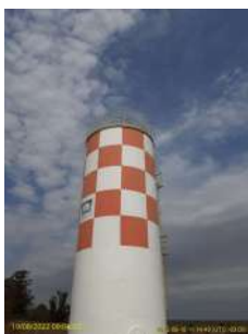
Foto 1 - Ausência de para-raios no Reservatório Terras do Francês
