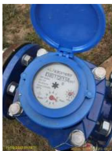
Foto 1 - Macromedidor do Poço 32
