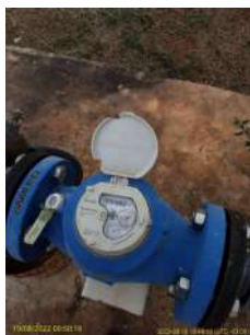
Foto 1 - Macromedidor do Poço 30 - Jatobá
