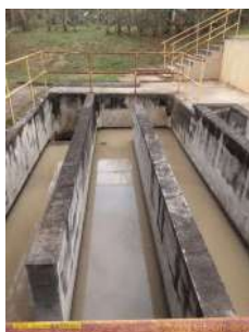
Foto 8 - Saída do efluente tratado.
