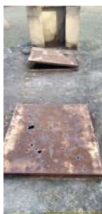
Foto 1 - Tampa de inspeção da EEE Bueno de Andrade
