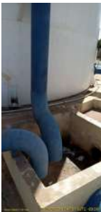
Foto 1 - Tubo extravasor do reservatório
