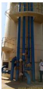
Foto 1 - Vista do extravasor do reservatório R18
