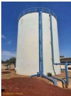
Foto 1 - Reservatório Planalto (R35)
