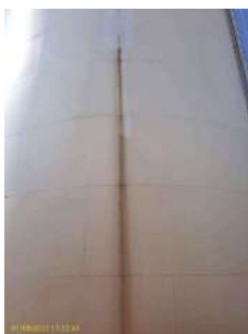
Foto 1 - Vista frontal do vazamento
