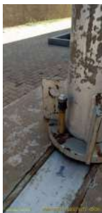
Foto 1 - Tubo de medidor de nível
