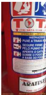
Foto 1 - Extintor de incêndio com validade vencida em 2021
