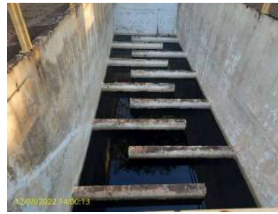
Foto 4 - Tanque de contato da ETE Bueno de Andrada
