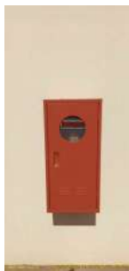
Foto 1 - Extintor de incêndio na parede externa da cabine do painel elétrico
