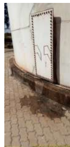
Foto 2 - Vazamento no reservatório Flora
