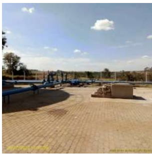
Foto 1 - Vista interna do Booster Flora
