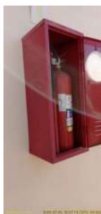
Foto 1 - Extintor de incêndio
