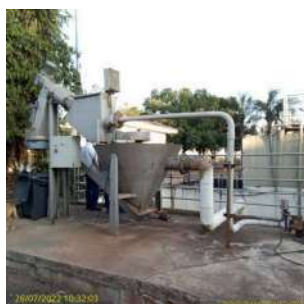
Foto 1 - Tratamento preliminar da ETE Bueno de Andrada
