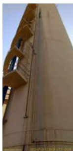
Foto 1 - Vazamento no reservatório R18
