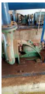
Foto 1 - Bombas do EEAT do centro de produção e reservação Selmi Dei
