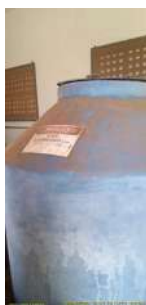
Foto 1 - Tanque de armazenamento de ácido fluorsilícico
