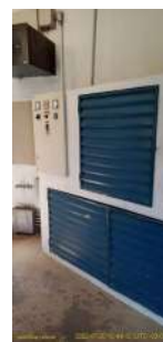
Foto 2 - Pannel elétrico do EEAT do centro de produção e reservação Selmi Dei
