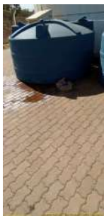
Foto 1 - Vazamento do tanque de hipoclorito de sódio
