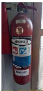
Foto 1 - Extintor de incêndio
