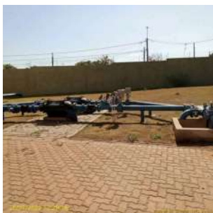
Foto 1 - Booster do centro de reservação São Rafael
