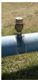
Foto 1 - Vazamento no TAP
