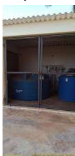
Foto 3 - Armazenamento de produtos químicos do centro de produção e reservacao Selmi Dei
