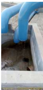
Foto 1 - Vazamento na vedação do registro
