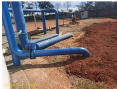
Foto 2 - Chegada da adutora de recalque da ETA Paiol e R35
