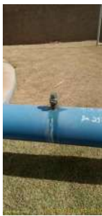
Foto 1 - Vazamento do TAP
