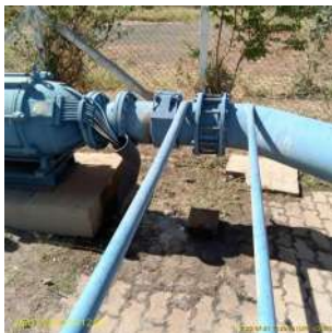
Foto 1 - Vazamento na válvula da retenção entre flanges
