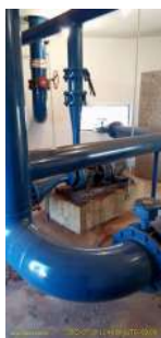
Foto 1 - EEAT no centro de produção e reservação Selmi Dei
