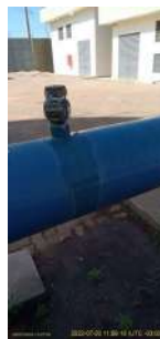
Foto 2 - Vazamento no TAP
