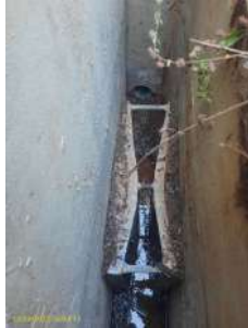
Foto 5 - Saída do esgoto tratado
