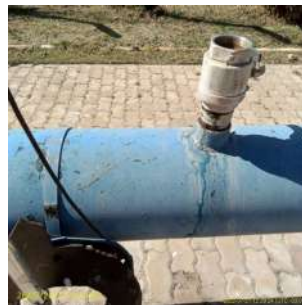
Foto 2 - Vazamento no TAP
