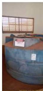
Foto 3 - Tanque de armazenamento de hipoclorito de sódio
