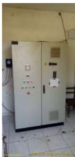
Foto 3 - Painel de controle e acionamento do conjunto motor-bomba submerso
