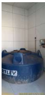
Foto 7 - Armazenamento e dosagem de cloro
