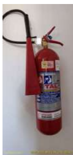
Foto 3 - Extintor de incêndio no interior da cabine do painel elétrico
