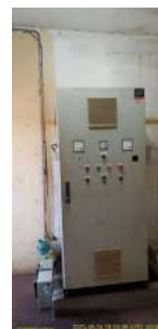
Foto 4 - Pannel de controle e acionamento do conjunto motor-bomba
