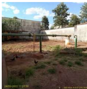
Foto 2 - Cavalete do poço tubular profundo Flamboyans
