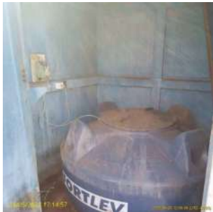
Foto 4 - Armazenamento e dosagem de cloro
