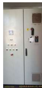
Foto 4 - Pannel de controle e acionamento do conjunto motor-bomba submerso
