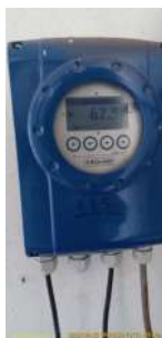
Foto 5 - Display do medidor de vazão do poço
