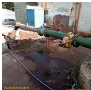
Foto 1 - Vazamento no cavalete do poço
