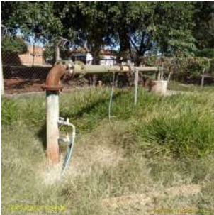
Foto 2 - Cavalete do poço tubular profundo Antônio Palocci II
