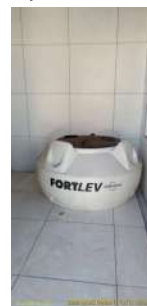
Foto 8 - Armazenamento e dosagem de flúor
