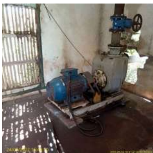
Foto 3 - Conjunto motor-bomba operante
