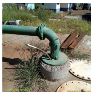
Foto 2 - Tubo de medição de nível do poço
