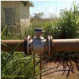
Foto 2 - Medidor de vazão do poço
