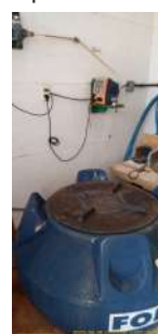
Foto 5 - Armazenamento e dosagem de flúor
