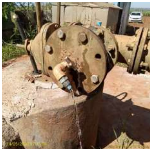
Foto 6 - Tomada para coleta de água do poço
