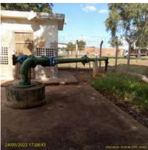
Foto 4 - Cavalete do poço tubular profundo Portinari III
