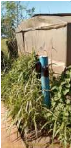
Foto 3 - Sensor de monitoramento
