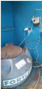
Foto 5 - Armazenamento e dosagem de flúor
