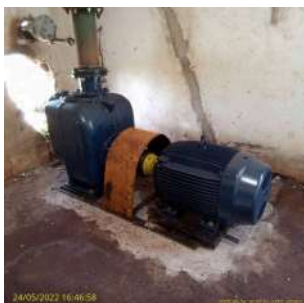
Foto 1 - Conjunto motor-bomba reserva fora de operação.
