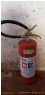
Foto 4 - Extintor de incêndio no interior da casa de bombas
