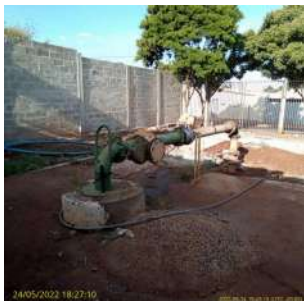
Foto 1 - Cavalete do poço Tubular Profundo Bananal III
