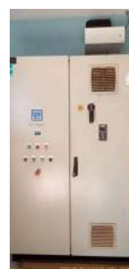
Foto 7 - Pannel de controle e acionamento do conjunto motor-bomba submerso
