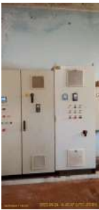
Foto 3 - Painel de controle e acionamento dos conjuntos motor-bomba
