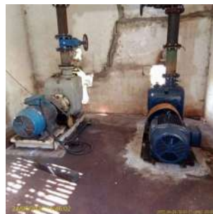
Foto 2 - Conjuntos motor-bombas no interior da elevatória Jardim Antônio Palocci
