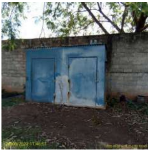
Foto 2 - Armazenamento e dosagem de cloro e flúor
