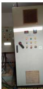
Foto 4 - Painel de controle e acionamento do conjunto motor-bomba submerso
