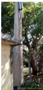
Foto 2 - Ausência de cabos elétricos
