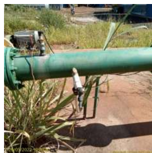
Foto 3 - Tomada para coleta de água do poço
