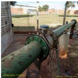
Foto 1 - Medidor de vazão do poço Portinari III
