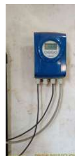
Foto 5 - Display do medidor de vazão do poço Bananal
