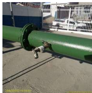
Foto 6 - Tomada para coleta de água do poço
