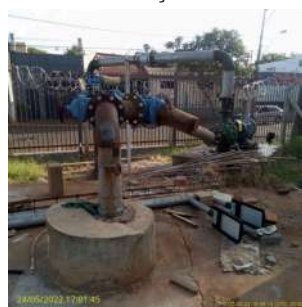
Foto 3 - Cavalete do poço tubular profundo Bananal IV e booster
