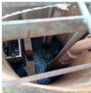
Foto 2 - Conjuntos motobombas submersos e cesto para remoção de resíduos grosseiros no interior do poço de sucção
