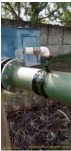
Foto 1 - Ponto 1 - Localização de vazamento
