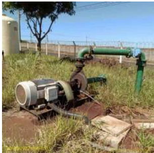
Foto 1 - Conjunto motobomba Distrito Industrial
