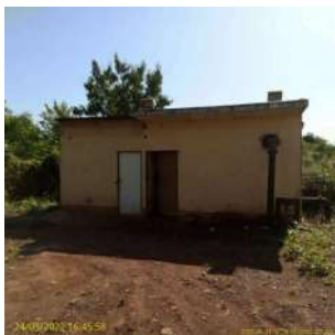
Foto 1 - Casa de bombas da estação elevatória de esgoto Jardim Antônio Palocci
