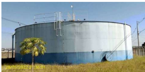
Foto 1 - Reservatório apoiado Distrito Industrial (capacidade 1500m3)
