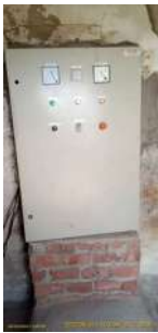
Foto 5 - Painel de comando e acionamento do conjunto motor-bomba submerso
