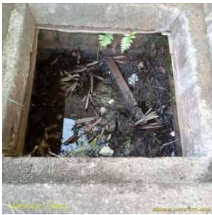
Foto 2 - Ponto 2 - Localização de vazamento
