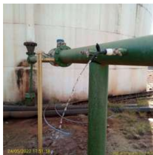
Foto 4 - Tomada para coleta de água do poço
