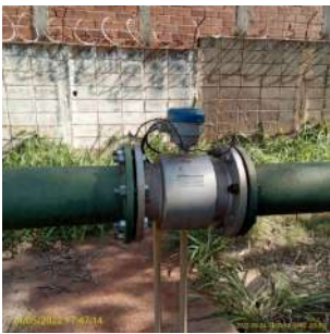
Foto 3 - Medidor de vazão
