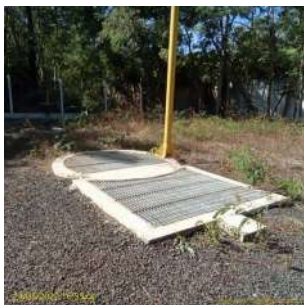
Foto 1 - Poço de sucção de esgoto bruto
