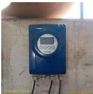
Foto 1 - Display do medidor de vazão do poço
