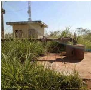
Foto 1 - Cavalete do poço tubular profundo Avelino Palma II
