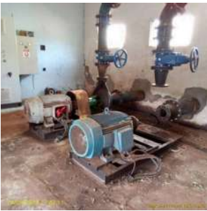
Foto 2 - Conjuntos motor-bombas no interior da elevatória Flamboyans
