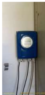
Foto 4 - Display do medidor de vazão do poço
