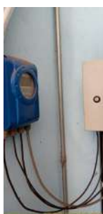
Foto 6 - Display do medidor de vazão do poço
