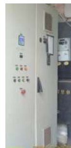
Foto 5 - Pannel de controle e acionamento do conjunto motor-bomba submerso
