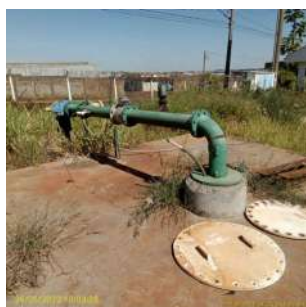
Foto 1 - Cavalete do poço tubular profundo Distrito Industrial
