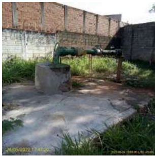
Foto 4 - Cavalete do poço tubular profundo Itabirite
