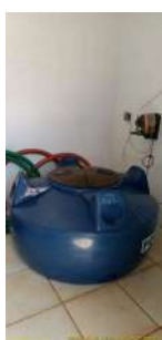
Foto 4 - Armazenamento e dosagem de cloro
