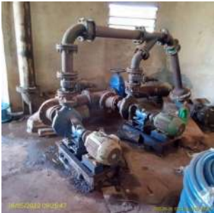
Foto 1 - Conjunto motobomba da estação elevatória de água Distrito Industrial
