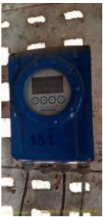
Foto 1 - Display do medidor de vazão do poço Itabirite
