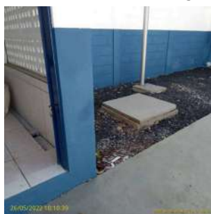
Foto 9 - Contenção de cloro e flúor do poço
