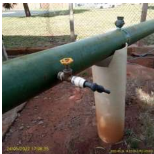
Foto 3 - Tomada para coleta de água do poço
