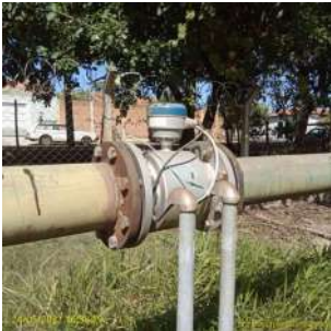
Foto 1 - Macromedidor de vazão do poço
