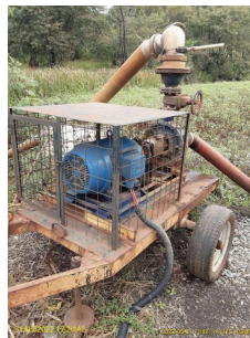
Foto 2 - Detalhe 1 da bomba.
