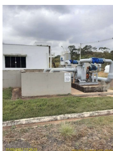
Foto 13 - Estação elevatória secundária.
