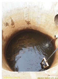
Foto 2 - Tanque auxiliar para separação do lodo da água de retrolavagem.
