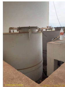
Foto 2 - Tanques de flúor.
