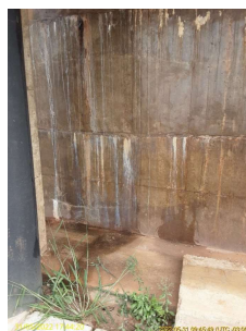
Foto 5 - Vazamento 2 na parte externa da ETA.
