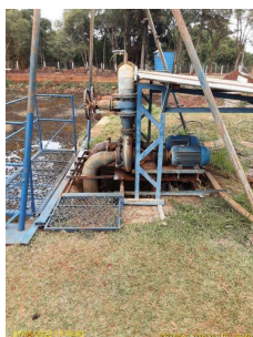
Foto 1 - Vista geral das bombas de captação.
