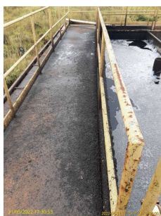
Foto 1 - Detalhe do esgoto nas passarelas e guarda-corpos que cercam o local de tratamento.
