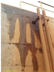
Foto 6 - Vazamento 3 na parte externa da ETA.
