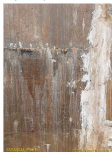
Foto 4 - Vazamento 1 na parte externa da ETA.
