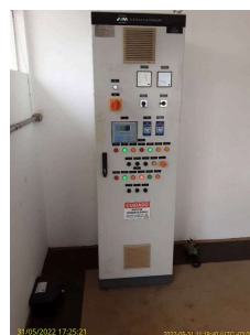
Foto 2 - Detalhe do painel elétrico.
