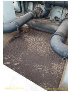
Foto 6 - Detalhe de lama nas estruturas da ETA. De acordo com o operador, a lama se deve a um evento isolado e que aos poucos está sendo retirada.
