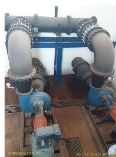
Foto 2 - Bombas usadas na retrolavagem.
