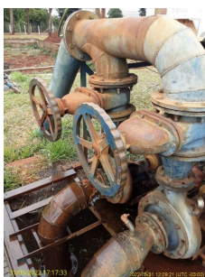
Foto 1 - Vazamento próximo às bombas.
