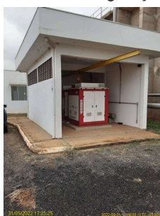
Foto 3 - Gerador junto à ETE.
