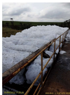
Foto 6 - Vista geral 3 da ETE.
