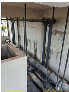
Foto 1 - Vazamentos sob a estrutura principal da ETA.
