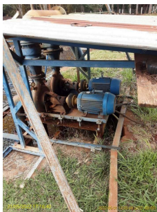
Foto 1 - Detalhe das bombas da captação.
