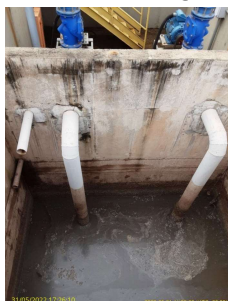
Foto 11 - Chegada do esgoto bruto.
