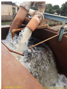
Foto 11 - Dosagem de PAC e pré-cloração na chegada da água bruta.
