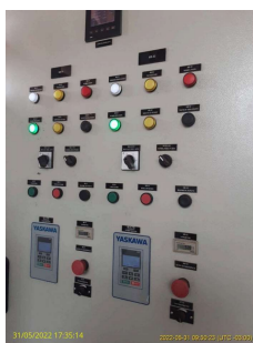
Foto 1 - Painéis elétricos da ETA.
