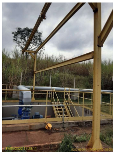
Foto 1 - Estruturas de apoio para manutenção das bombas.
