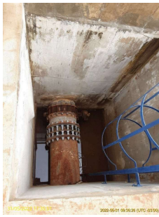
Foto 5 - Detalhe de conexão entre dois módulos da ETA.
