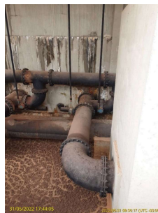
Foto 2 - Detalhe dos vazamentos sob a estrutura principal da ETA.
