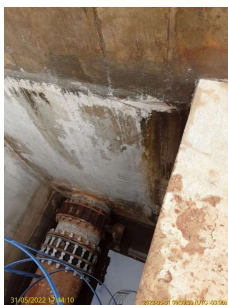
Foto 3 - Vazamento junto à conexão entre os módulos da ETA.
