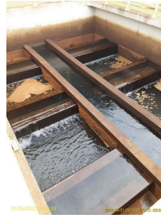
Foto 8 - Detalhe dos filtros.
