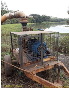
Foto 3 - Detalhe 2 da bomba.
