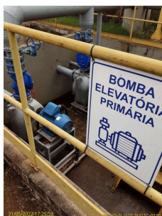
Foto 9 - Bombas na chegada da ETE.
