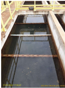
Foto 9 - Detalhe dos decantadores.
