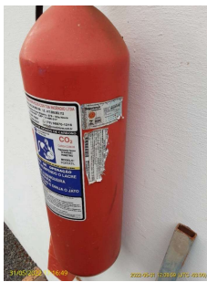
Foto 1 - Extintor de incêndio próximo ao painel elétrico.
