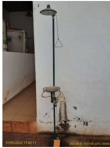
Foto 1 - Chuveiro de emergência 1, próximo ao armazenamento de produtos químicos.
