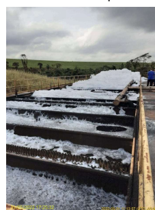
Foto 4 - Vista geral 1 da ETE. De acordo com o Prestador, a espuma branca se deve à sobrecarga ocasionada pela chuva no dia anterior.
