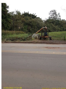
Foto 1 - Vegetação sem poda junto à bomba da captação.
