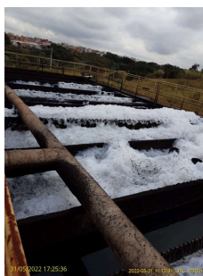
Foto 5 - Vista geral 2 da ETE.
