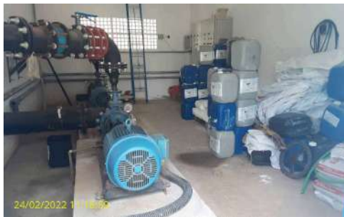
Foto 1 - Conjuntos motobomba da elevatória
