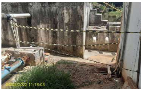
Foto 1 - Buraco não fechado após reparo da tubulação
