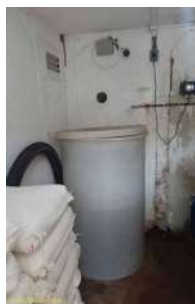
Foto 1 - Tanque de flúor
