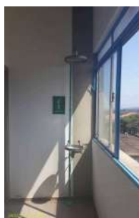
Foto 1 - Chuveiro de emergência instalado na ETA
