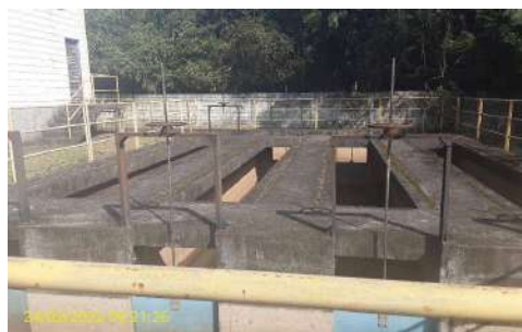
Foto 7 - Aspecto geral das comportas da tomada de água
