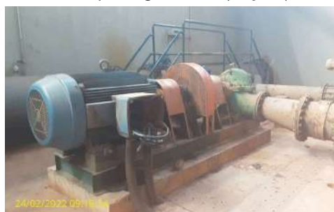
Foto 5 - Vista do conjunto motobomba em maior detalhe
