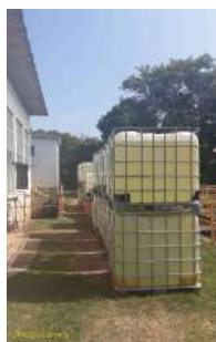
Foto 3 - Bombonas de cloro dispostas próximas ao canal de entrada da água
