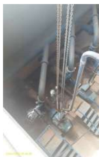
Foto 1 - Vazamento de água de drenagem das gaxetas
