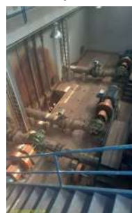
Foto 4 - Aspecto geral da captação (inteno)
