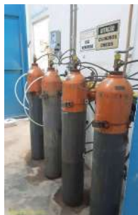
Foto 7 - Tanques de cloro gás
