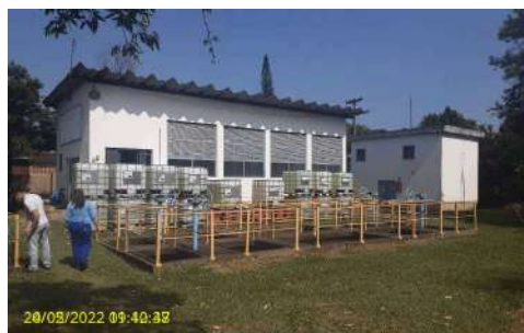
Foto 2 - Disposição das bombonas de cloro próximas à entrada de água na captação
