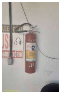
Foto 1 - Extintor de incêndio no interior da captação
