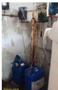
Foto 1 - Bomba de cloração da água
