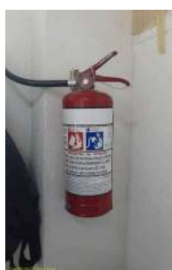
Foto 1 - Extintor de incêndio da ETA
