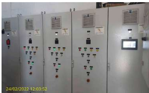
Foto 3 - Painéis de acionamento e controle dos conjuntos motobomba
