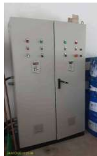
Foto 2 - Pannel de controle e acionamento dos conjuntos motobomba
