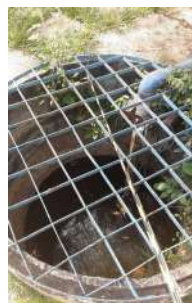
Foto 4 - Poço de sucção
