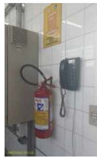
Foto 2 - Extintor de incêndio instalado na ETA
