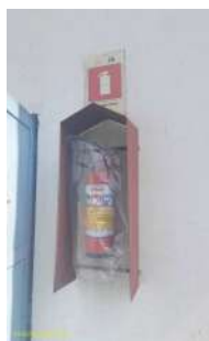
Foto 4 - Extintor de incêndio da captação
