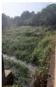
Foto 6 - Aspecto geral da entrada da água na captação, com vegetação obstruindo parte da passagem
