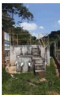
Foto 1 - Escada de acesso ao tanque de contato sem guarda corpo em uma das laterais
