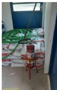
Foto 1 - Extintor de incêndio no interior da elevatória
