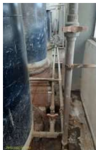
Foto 1 - Vazamento de água atrás dos tanques
