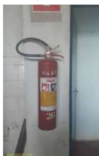
Foto 3 - Extintor de incêndio da captação superficial
