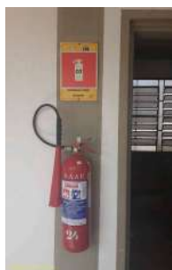
Foto 1 - Extintor de incêndio instalado na ETA
