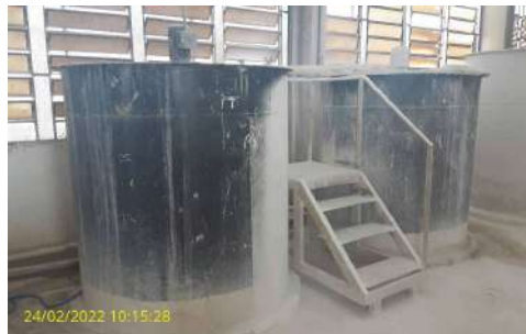
Foto 5 - Tanques de preparação do cal
