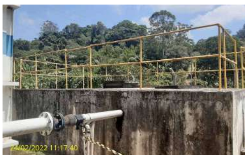
Foto 6 - Tanque de contato
