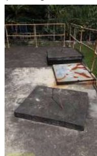
Foto 7 - Tampas de inspeção do tanque de contato
