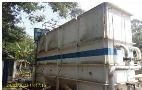
Foto 5 - Aspecto geral da ETA compacta
