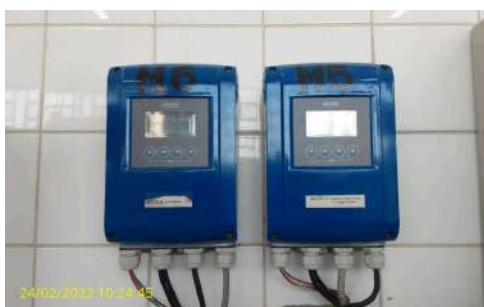
Foto 1 - Painel de monitoramento da vazão da ETA
