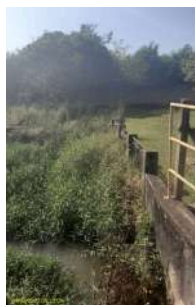
Foto 1 - Vegetação obstruindo a passagem da tomada d'água
