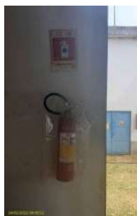
Foto 1 - Extintor de incêndio próximo aos conjuntos motobomba
