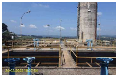
Foto 10 - Aspecto geral da ETA
