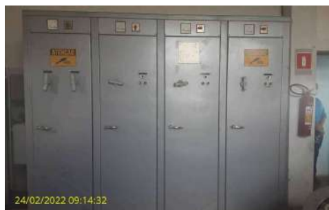
Foto 2 - Painéis elétricos de acionamento e controle dos conjuntos motobomba
