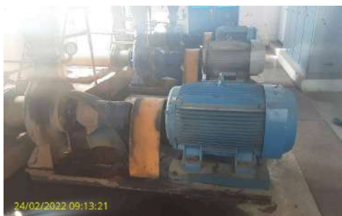
Foto 1 - Conjuntos motobomba da captação superficial
