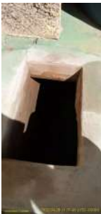
Foto 3 - Entrada de água no reservatório proveniente do poço horta/motocross
