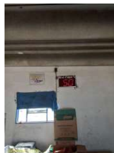
Foto 2 - Nível do reservatório elevado. O painel fica situado junto ao reservatório semienterrado, onde fica o operador.
