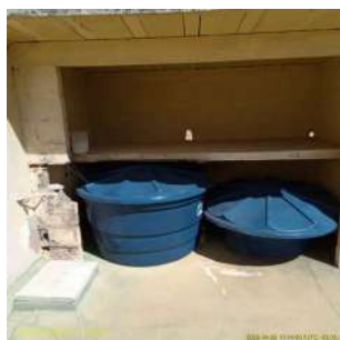
Foto 1 - Armazenamento de cloro e flúor. A dosagem é feita no reservatório semienterrado, que recebe a água do poço Castelo.
