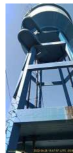
Foto 2 - Observa-se escada sem guarda-corpo adequado.
