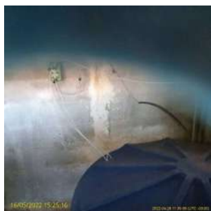
Foto 1 - Bomba dosadora de produto químico
