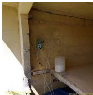
Foto 2 - Bomba dosadora de produto químico.
