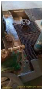
Foto 2 - Verificou-se uma mangueira que, segundo o prestador, foi colocada devido a um vazamento no registro.
