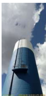
Foto 1 - Para-raios no reservatório.
