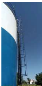
Foto 1 - Escada cm guarda-corpo para manutenção.
