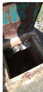
Foto 2 - Verifica-se tampa de inspeção com corrosão, devendo ser substituída.
