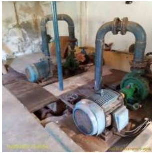
Foto 1 - Bombas da elevatória.
