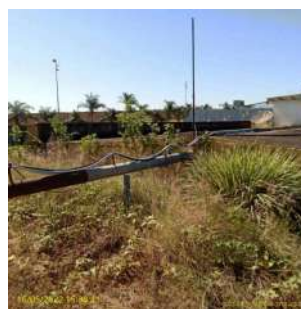
Foto 2 - Tubulação de entrada do reservatório, abastecido pelo poço.
