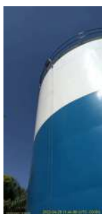
Foto 1 - Medidor de nível sem funcionamento., devendo ser adequado.
