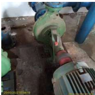
Foto 1 - Verifica-se que a água que lubrifica as gaxetas acumula no local.
