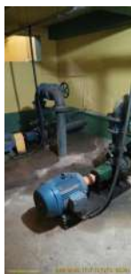
Foto 1 - Bombas que abastecem o reservatório elevado Castelo
