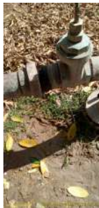
Foto 1 - Vazamento observado na tubulação do poço.
