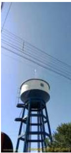
Foto 1 - Para-raios no reservatório.
