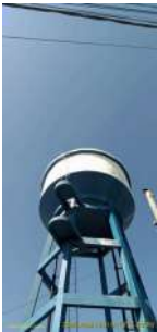
Foto 1 - O reservatório possui medidor de nível (pêndulo ao lado do último trecho da escada)
