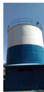
Foto 2 - Reservatório e abrigo de produtos químicos.
