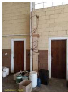
Foto 2 - Bombas do poço no almoxarifado da prefeitura.
