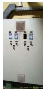
Foto 2 - Painel elétrico das bombas.
