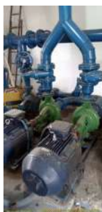
Foto 3 - Conjuntos moto bomba da elevatória: um em operação e outro reserva.
