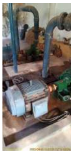
Foto 1 - Conjunto motobomba reserva instalado no local.
