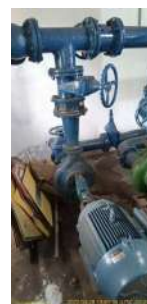
Foto 4 - Conjunto moto bomba da elevatória.
