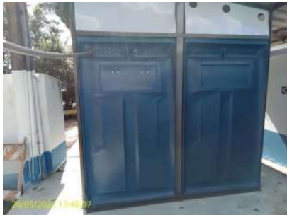
Foto 1 - Abrigo para armazenamento de produtos químicos dosados diretamente no reservatório.
