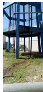
Foto 2 - Vazamento observado no reservatório.
