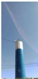
Foto 1 - Para-raios no reservatório.
