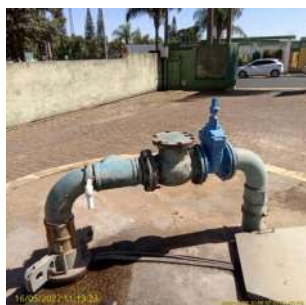
Foto 1 - Não existe macromedidor de vazão no poço.
