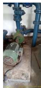
Foto 2 - Conjunto moto bomba da elevatória.
