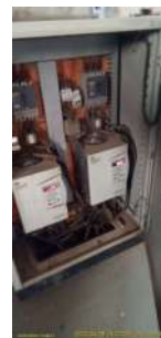
Foto 2 - Painel elétrico exibe umas das bombas em operação e outra reserva.
