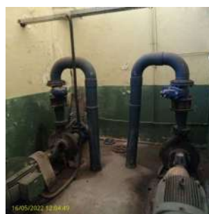
Foto 3 - Bombas que abastecem o reservatório Vila Bandeirantes
