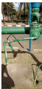
Foto 1 - Tomada de água bruta no poço.
