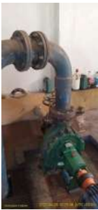
Foto 1 - Mangueira direcionando água que estava vazando
