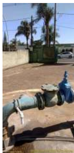
Foto 1 - O poço, apesar de estar situado em uma área da prefeitura, está exposto, sem o devido isolamento.
