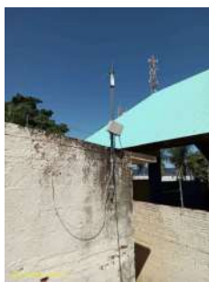
Foto 1 - Antena, situada no conjunto Castelo/Centro, que recebe sinal do nível do reservatório Bandeirantes.
