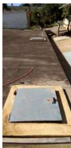
Foto 1 - Tampas de inspeção.
