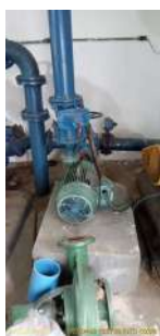
Foto 1 - Conjunto moto bomba da elevatória.
