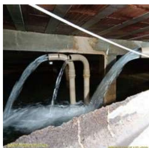
Foto 1 - Entradas de água do reservatório.
