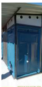
Foto 1 - Abrigos para armazenamento de cloro e flúor.
