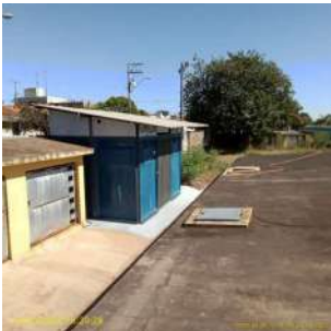
Foto 1 - Reservatório e abrigos para armazenamento de produtos químicos
