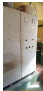
Foto 2 - Painel elétrico da bomba do poço.
