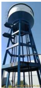
Foto 1 - Vazamento de grandes proporções no reservatório
