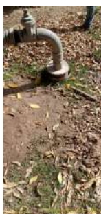
Foto 1 - Ausência de laje de proteção.
