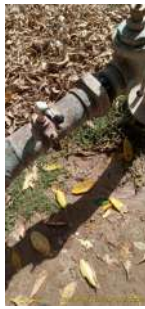
Foto 1 - Torneira para coleta de água bruta.
