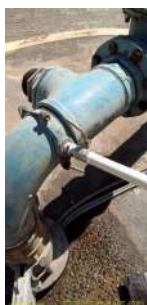
Foto 1 - Vazamento verificado na captação.
