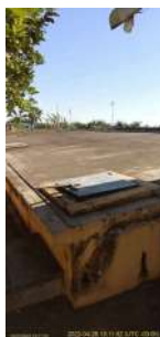
Foto 1 - Reservatório semi enterrado. Observa-se trincas na alvenaria.
