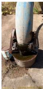
Foto 1 - Vazamento verificado no poço.
