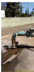
Foto 1 - Torneira para coleta de água bruta.
