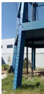
Foto 1 - Escada inadequada para manutenção.
