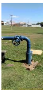
Foto 1 - Poço sem isolamento adequado.
