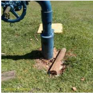
Foto 1 - Ausência de laje de proteção.
