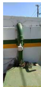
Foto 2 - Medidor de vazão na entrada do Reservatório.
