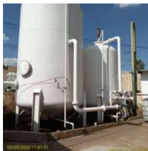
Foto 5 - Visão geral dos módulos da ETA III
