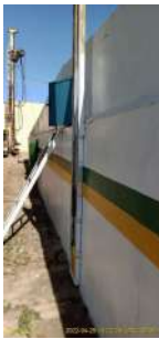
Foto 2 - Medidor de nível instalado no reservatório, com marcação dos níveis
