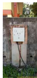
Foto 2 - Painel elétrico do poço.
