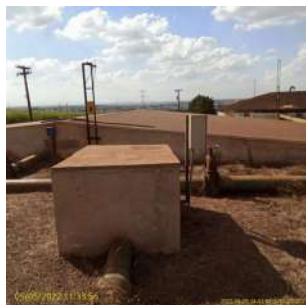
Foto 1 - Macromedidor de saída da ETA: equipamento está inoperante
