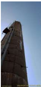
Foto 2 - Medidor de nível do reservatório antigo
