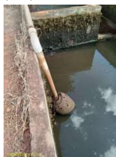
Foto 5 - Bombeamento de água para retorno À ETA
