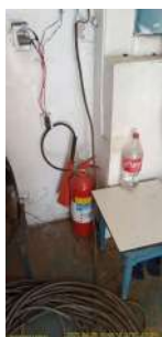
Foto 1 - Extintor de incêndio em sala existente junto à elevatória. Verifica-se a disposição e sinalização inadequada.
