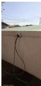
Foto 1 - Tubo de ventilação sem tela de proteção contra entrada de insetos.
