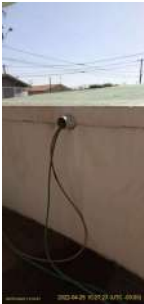
Foto 1 - Ventilação do reservatório.
