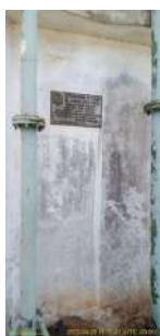
Foto 1 - Placa de identificação do reservatório
