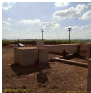
Foto 2 - Outro medidor de vazão na saída da ETA, também inoperante
