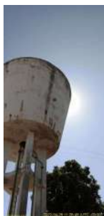
Foto 1 - O prestador afirmou que o pêndulo existente não funciona para medir o nível do reservatório
