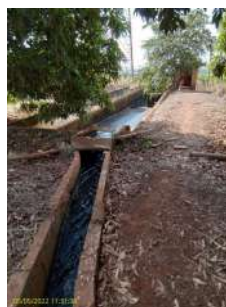
Foto 2 - Canaleta encaminha o lodo a um tanque
