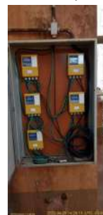
Foto 4 - Macromedidores de entrada da ETA I, em funcionamento.
