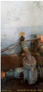
Foto 1 - Vazamento em registro da elevatória.
