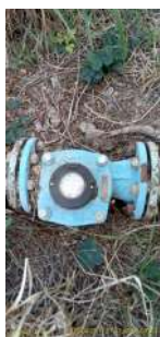
Foto 3 - Medidor de vazão na saída do reservatório.
