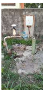
Foto 1 - Laje de proteção danificada, necessitando de manutenção
