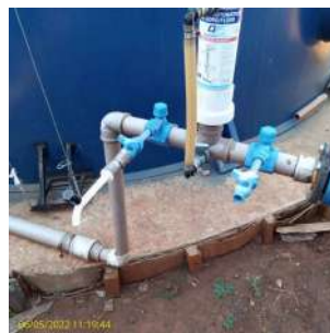
Foto 4 - Chegada da água do Poço São Carlos, que fica em outro local. A imagem exibe a aplicação de cloro, realizada na chegada ao reservatório.
