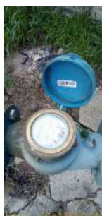
Foto 1 - Macromedidor de vazão
