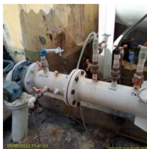
Foto 4 - Tomada de água bruta e dosagens de produtos químicos.
