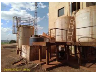
Foto 3 - Tanques dispostos sem contenção.
