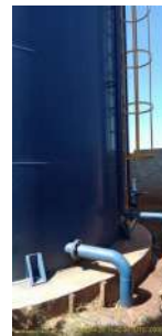
Foto 2 - Novo reservatório metálico existente no local.
