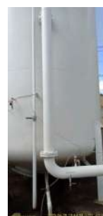
Foto 2 - Módulo de floculação e decantação.
