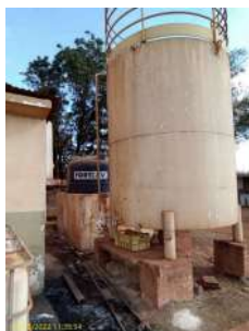
Foto 1 - Tanque de produto químico disposto inadequadamente, sem contenção.
