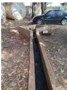
Foto 1 - Canaleta que recebe o lodo do tratamento
