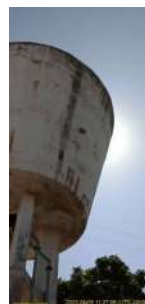
Foto 2 - Há pêndulo para medição de nível, porém não está em funcionamento.
