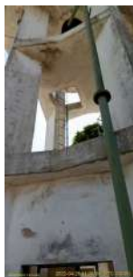
Foto 1 - A escada de acesso não possui guarda-corpo apropriado.
