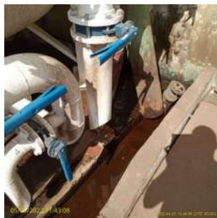
Foto 1 - Canaleta que recebe lodo do tratamento.
