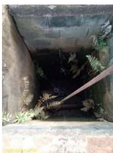
Foto 4 - Caixa com registro de tubulação que encaminha o lodo para plantação de cana.
