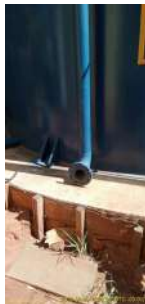
Foto 1 - Tubo extravasor do reservatório novo.
