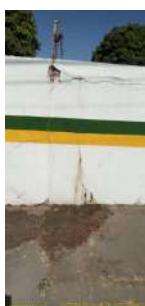
Foto 1 - Vazamento constatado no reservatório.
