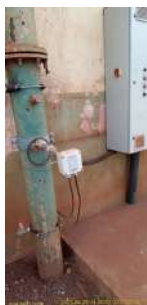
Foto 3 - Macromedidor de entrada da ETA II, ao lado da ETA I
