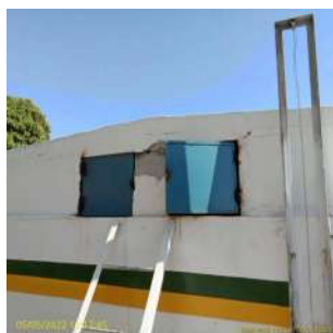
Foto 1 - Tampas do acesso para inspeção.
