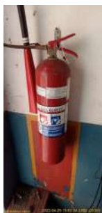
Foto 1 - Extintor de incêndio existente no local.
