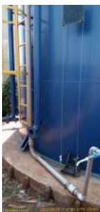
Foto 1 - Tubo extravasor do reservatório novo.
