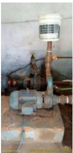
Foto 1 - Vista da elevatória a partir da entrada.
