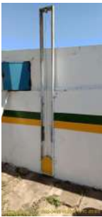
Foto 1 - Medidor de nível instalado no reservatório.
