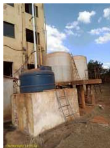
Foto 2 - Tanques de produtos químicos dispostos inadequadamente, sem contenção.
