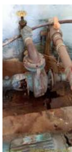
Foto 1 - Água de lubrificação acumulada na elevatória.
