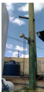
Foto 1 - Macroedidor situado na saída da ETA III; na entrada, não há macromedidor.
