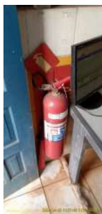
Foto 3 - Extintor de incêndio no laboratório da ETA III
