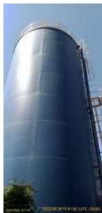
Foto 1 - Novo reservatório metálico existente no local.
