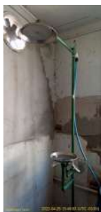
Foto 1 - Chuveiro de emergência da ETA III
