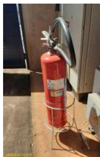
Foto 5 - Extintor de incêndio com etiqueta com data da última manutenção de 2º nível
