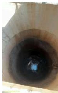
Foto 4 - Poço de entrada do efluente
