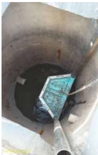
Foto 3 - Cesto para remoção de sólidos grosseiros
