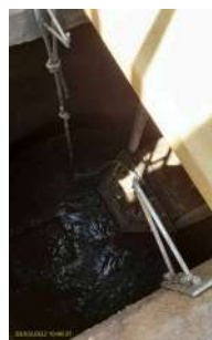
Foto 8 - Cesto de retenção dos sólidos grosseiros
