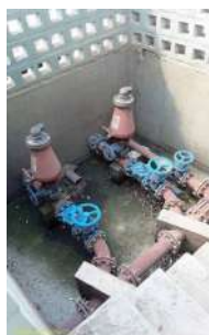
Foto 2 - Ventosas instaladas no barrilete
