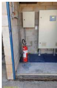
Foto 1 - Extintor de incêndio no interior da cabine
