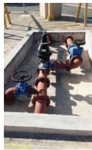
Foto 2 - Barrilete da elevatória, com ventosa instalada
