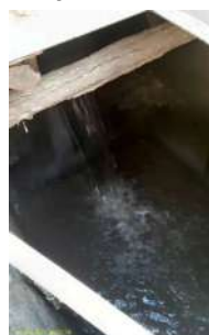
Foto 7 - Entrada do efluente na elevatória
