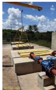
Foto 8 - Aspecto geral da elevatória
