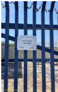
Foto 1 - Placa de identificação da elevatória de esgoto
