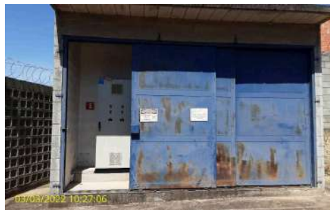
Foto 2 - Cabine dos painéis elétricos
