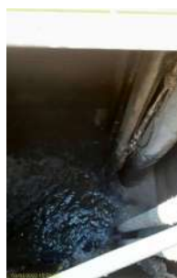
Foto 6 - Poço de sucção do efluente
