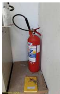
Foto 1 - Extintor de incêndio no interior da cabine de painéis elétricos
