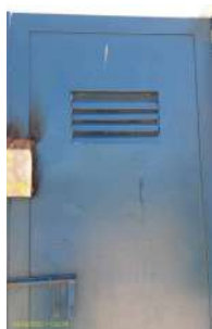
Foto 1 - Cabine do painel elétrico de acionamento e controle dos conjuntos motobomba
