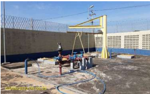
Foto 2 - Aspecto geral da elevatória
