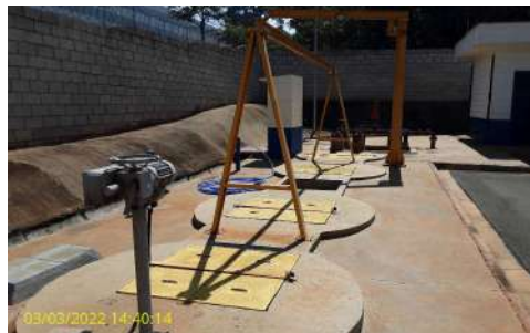
Foto 3 - Aspecto geral da elevatória
