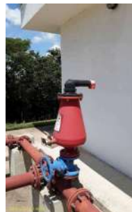
Foto 4 - Ventosa instalada no barrilete
