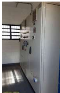
Foto 6 - Painéis elétricos de controle e acionamento dos conjuntos motobomba
