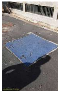
Foto 3 - Área de limpeza do gradeamento
