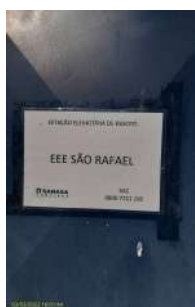
Foto 1 - Placa de identificação da elevatória
