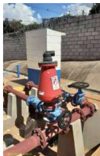
Foto 4 - Ventosa instalada no barrilete
