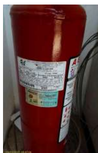
Foto 1 - Etiqueta com data de manutenção de 2º nível do extintor. Próxima manutenção deveria ter sido realizada em Fevereiro/2022. Logo, a manutenção está com a validade expirada
