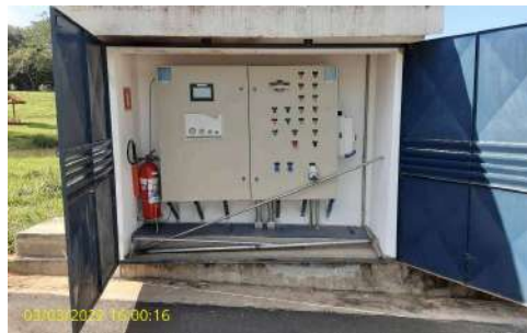
Foto 6 - Painel elétrico de controle e acionamento dos conjuntos motobomba
