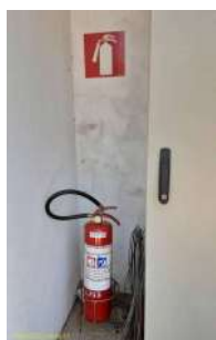
Foto 5 - Extintor de incêndio no interior da cabine
