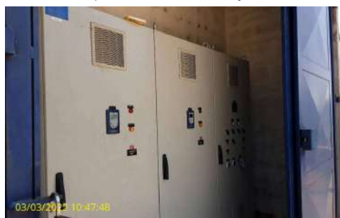
Foto 6 - Painéis elétricos de controle e acionamento dos conjuntos motobomba
