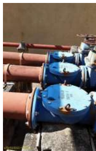
Foto 8 - Barrilete com válvulas de retenção
