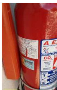
Foto 1 - Etiqueta com data da última manutenção de nível 2 realizada no extintor
