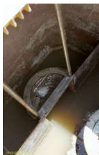
Foto 11 - Segundo cesto de retenção de sólidos grosseiros
