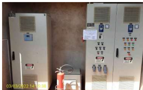
Foto 4 - Cabine dos painéis de acionamento e controle dos conjuntos motobomba
