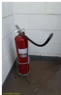
Foto 1 - Extintor de incêndio da elevatória de esgoto, com etiqueta com data da última manutenção de 2º nível
