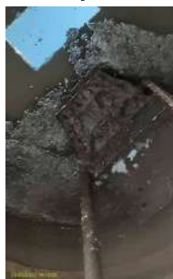
Foto 6 - Primeiro cesto de retenção dos sólidos grosseiros
