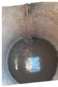
Foto 4 - Poço de entrada do efluente
