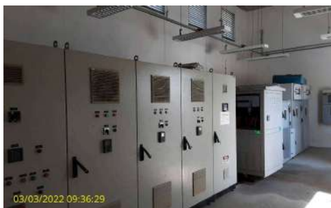
Foto 5 - Painéis de controle e acionamento dos conjuntos motobomba
