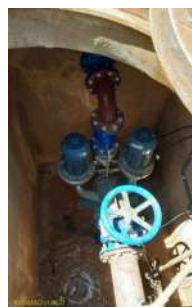
Foto 2 - Conjuntos motobomba no interior da elevatória
