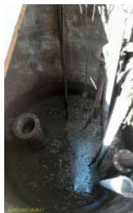
Foto 8 - Poço de sucção do efluente
