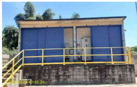
Foto 4 - Cabine dos painéis elétricos dos conjuntos motobombas. Cabine encontra-se em nível elevado, pois é uma área sujeita à inundação
