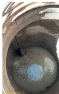
Foto 7 - Poço de entrada do efluente
