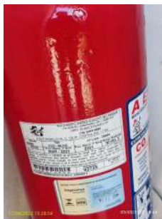
Foto 1 - Extintor de incêndio com etiqueta com data de manutenção de 2º nível
