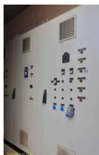
Foto 3 - Painel elétrico de controle e acionamento dos conjuntos motobomba
