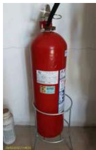
Foto 5 - Extintor de incêndio com etiqueta com data de manutenção do 2º nível
