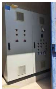
Foto 3 - Painéis elétricos de controle e acionamento dos conjuntos motobomba
