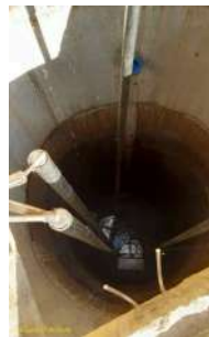
Foto 5 - Cesto para remoção de sólidos grosseiros
