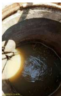
Foto 7 - Poço de entrada do efluente
