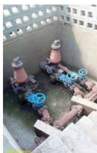
Foto 1 - Ausência de guarda-corpo na escada de acesso ao barrilete
