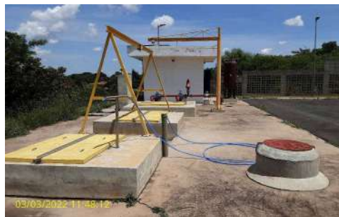
Foto 2 - Aspecto geral da elevatória
