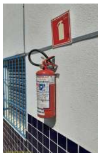
Foto 3 - Extintor de incêndio da elevatória
