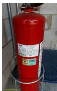
Foto 1 - Etiqueta com data da próxima manutenção
