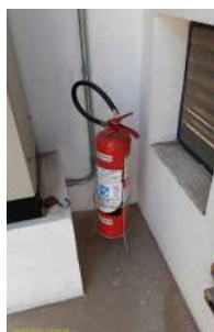
Foto 1 - Extintor de incêndio no interior da cabine do painel elétrico
