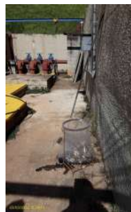
Foto 9 - Rastelo e cesto para limpeza e descarte dos resíduos do gradeamento
