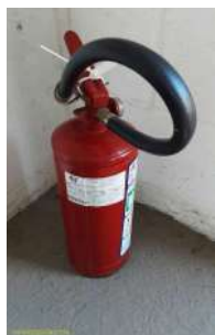
Foto 1 - Extintor de incêndio da elevatória
