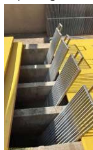
Foto 5 - Gradeamento de retenção dos sólidos grosseiros
