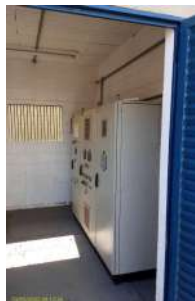
Foto 6 - Paineis de controle e acionamento dos conjuntos motobomba
