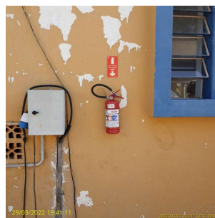
Foto 2 - Extintor de incêndio próximo ao tanque de hipoclorito de sódio
