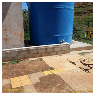
Foto 1 - Fotografia ilustrando a ausência de cercamento em torno do reservatório. Há cercamento apenas em torno do poço.
