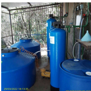
Foto 1 - Detalhe do armazenamento de flúor no abrigo próximo ao poço.
