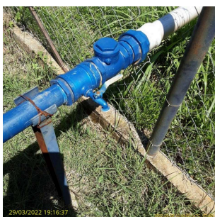
Foto 1 - Detalhe da torneira para coleta de água
