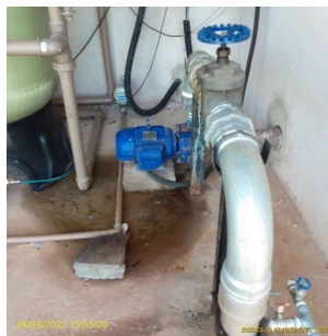
Foto 2 - Booster junto ao reservatório
