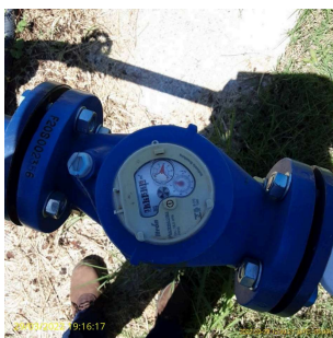
Foto 1 - Detalhe do macromedidor
