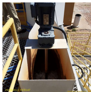
Foto 6 - Chegada da água bruta
