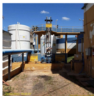
Foto 4 - Vista do tanque de hipoclorito de sódio (o Prestador informou que não utiliza cloro gás).
