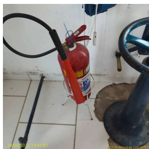
Foto 1 - Extintor de incêndio junto ao laboratório
