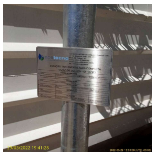
Foto 1 - Placa de identificação da ETA Compacta
