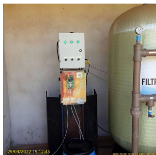
Foto 3 - Detalhe do painel elétrico
