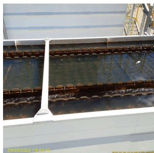
Foto 1 - Vertedores de água decantada
