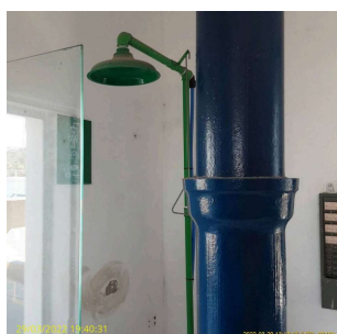
Foto 1 - Chuveiro de emergência no laboratório
