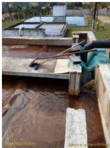
Foto 1 - Chegada de água bruta das captações ao módulo de pré-filtração da ETA
