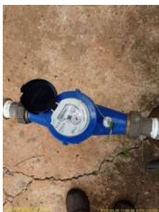
Foto 1 - Macromedidor do poço.
