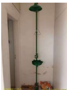
Foto 1 - Chuveiro de emergência no laboratório.
