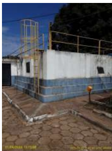
Foto 1 - Reservatório de alvenaria situado junto à ETA
