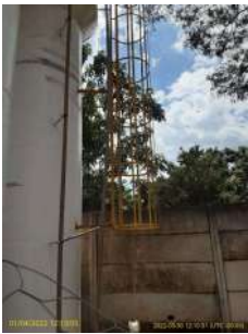
Foto 1 - Escada com guarda-corpo de um dos reservatórios. O outro possui nas mesmas condições.
