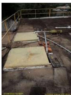
Foto 1 - Tampas de inspeção.
