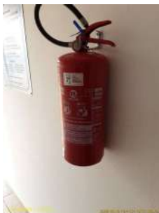
Foto 1 - Extintor na ETA.
