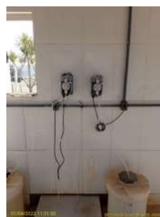
Foto 2 - Bombas dosadoras de cloro e flúor.
