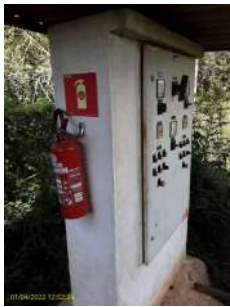
Foto 1 - Extintor de incêndio junto ao quadro elétrico.
