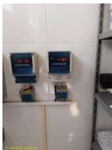
Foto 1 - Medidor de nível dos reservatórios junto à ETA.
