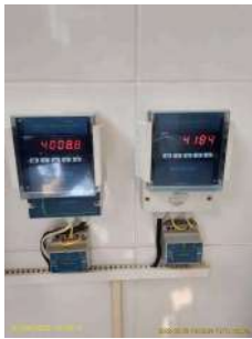
Foto 1 - Medidor de nível dos reservatórios da ETA
