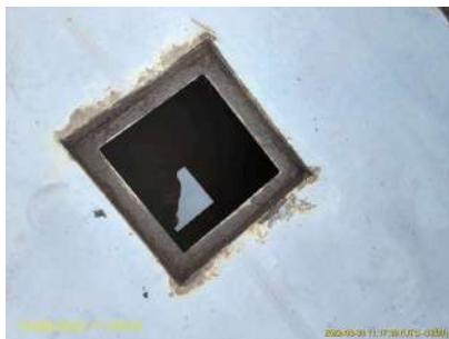
Foto 1 - Caixa alagada contendo medidor, situado já na rede de distribuição.
