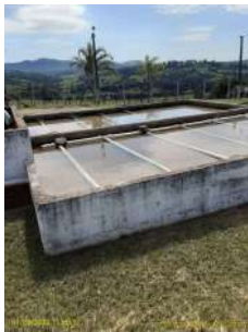
Foto 3 - Módulo de filtração.
