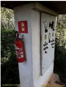
Foto 3 - Painel de comando da elevatória.
