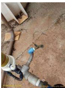
Foto 1 - Torneira para tomada de água bruta.
