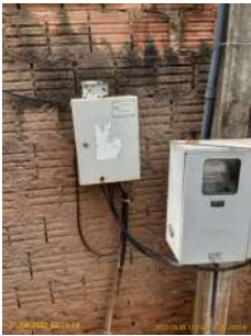
Foto 2 - Painel de comando do bombeamento do poço.
