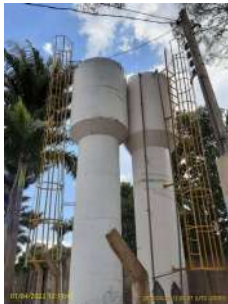
Foto 1 - 2 reservatórios de 15 m³ cada, em sistema de vasos comunicantes.
