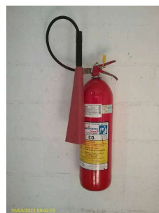
Foto 5 - Extintor de incêndio
