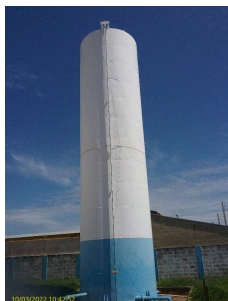
Foto 1 - Reservatório São Francisco elevado
