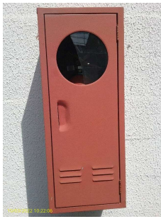
Foto 3 - Extintor de incêndio
