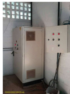
Foto 2 - Painel de comando e controle
