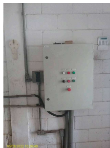
Foto 2 - Pannel de comando e controle
