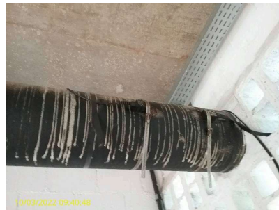
Foto 3 - Macromedidor de vazão instalado na tubulação
