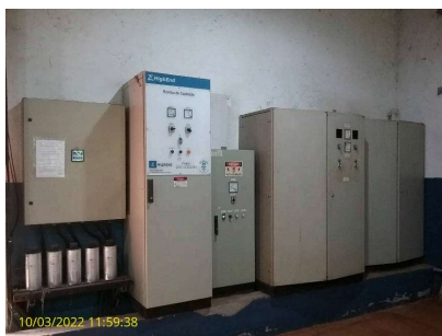
Foto 3 - Paineis de comando e controle
