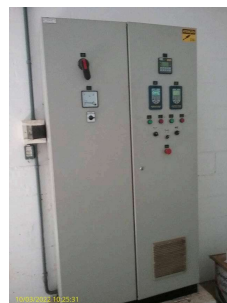
Foto 2 - Painel de comando e controle
