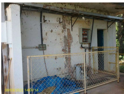
Foto 1 - Pannel elétrico sem tampa
