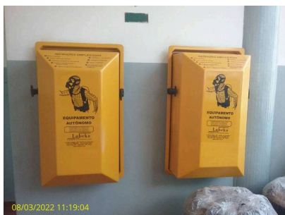
Foto 19 - Kits de emergência de cloro gás
