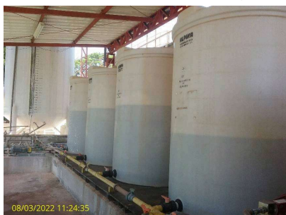
Foto 23 - Tanques de PAC
