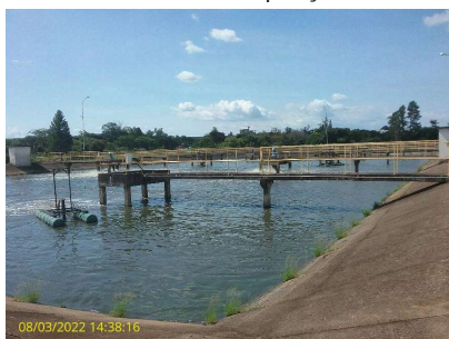
Foto 5 - Tanque de aeração (antigo)
