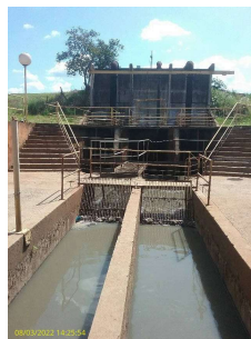
Foto 2 - Canal de entrada de esgoto bruto
