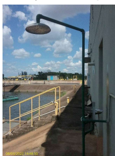
Foto 7 - Chuveiro de emergência
