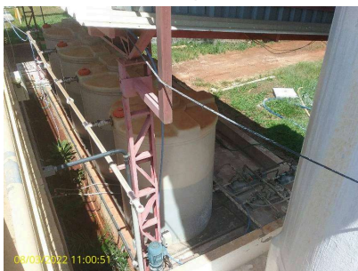
Foto 7 - Tanque de PAC
