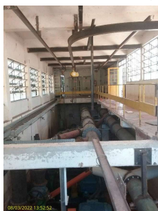
Foto 5 - vista geral da casa de bombas
