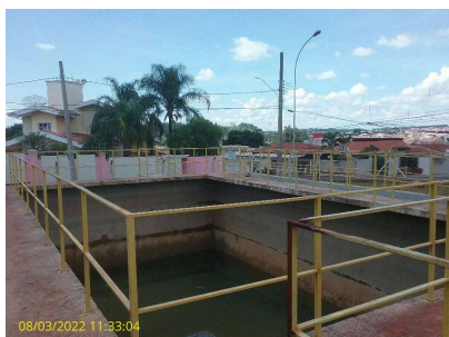
Foto 27 - Tanque de separação
