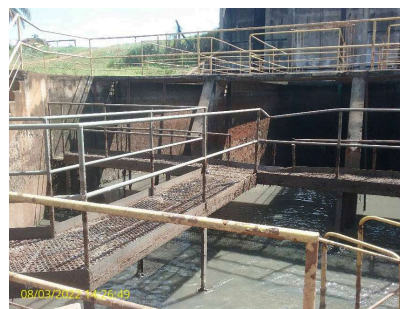
Foto 2 - Passarela e guarda-corpo em condições inadequadas
