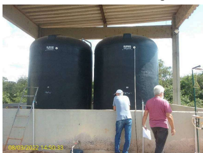
Foto 9 - Armazenamento de produto químico
