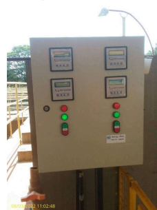
Foto 8 - Painel medidor de vazão
