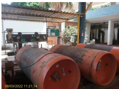
Foto 21 - Cilindro de cloro gás
