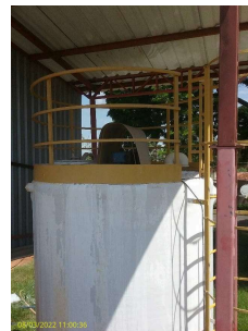
Foto 6 - Tanque de Hidróxido de cálcio
