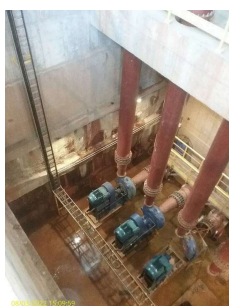
Foto 1 - Infiltração subterrânea pelas paredes do poço da elevatória
