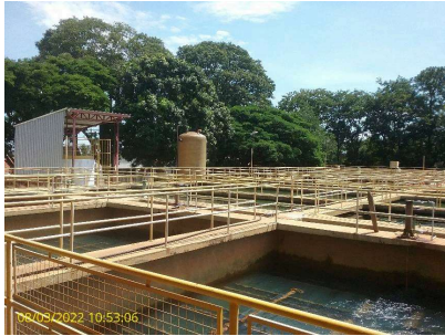
Foto 1 - Vista geral da ETA
