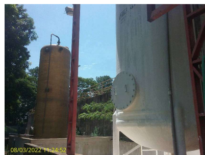
Foto 24 - Tanque de Hidróxido de Cálcio
