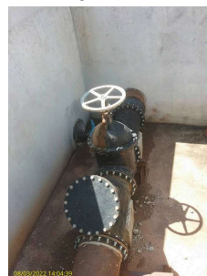
Foto 8 - Caixa de manobra da adutora
