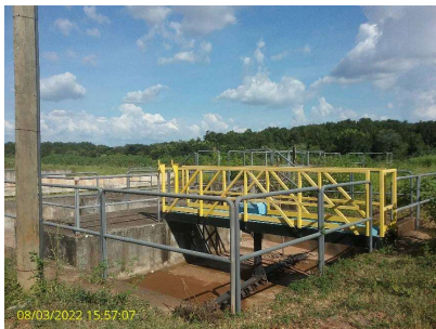
Foto 7 - Estrutura de entrada de esgoto bruto
