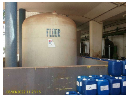
Foto 22 - Tanque de flúor
