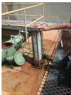
Foto 1 - Válvula de acionamento das comportas
