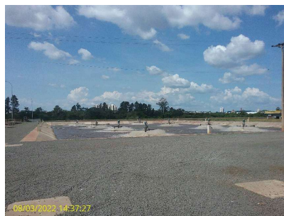
Foto 4 - Tanque de aeração (ampliação)
