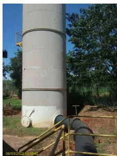
Foto 3 - Reservatório de água bruta
