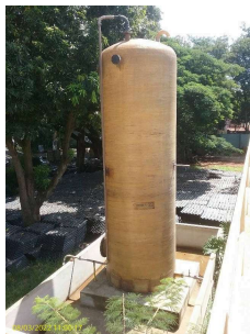
Foto 5 - Tanque de cloro
