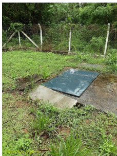
Foto 4 - Poço da chegada do efluente.
