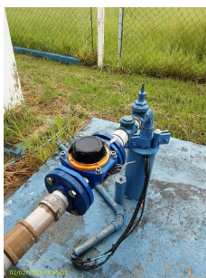
Foto 1 - Macromedidor do poço.
