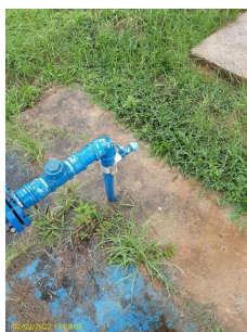
Foto 1 - Torneira para tomada de água.
