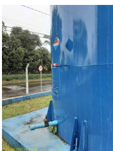
Foto 1 - Medidor de nível no reservatório II.
