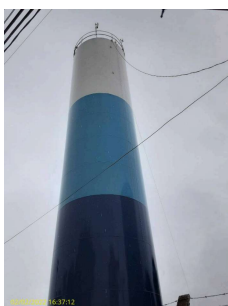
Foto 1 - Para-raio no reservatório II, o mais alto.
