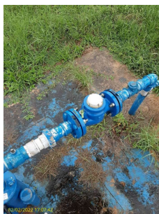
Foto 1 - Macromedidor do poço.
