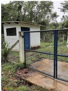
Foto 1 - Elevatória de Esgoto Pinheiro, localizada na Rua Brigida Rossi
