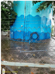
Foto 1 - Medidor de nível do reservatório.
