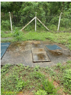
Foto 5 - Poço de sucção da elevatória.
