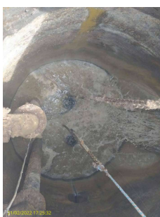
Foto 1 - Bombas no poço de sucção da elevatória de esgoto.
