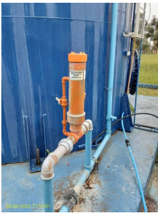
Foto 1 - Clorador da captação.
