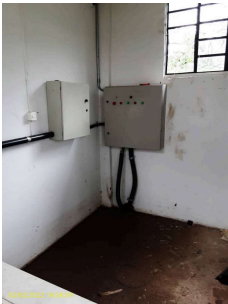
Foto 2 - Pannel elétrico da EEEB
