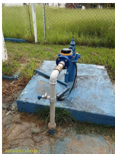
Foto 1 - Torneira para tomada de água.
