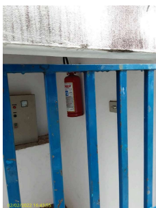
Foto 1 - Extintor localizado junto à captação.
