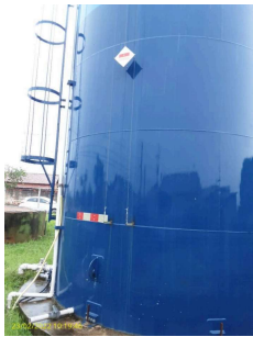
Foto 1 - Medidor de nível do reservatório.
