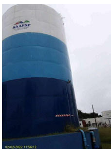
Foto 1 - Tubo sem tela de proteção
