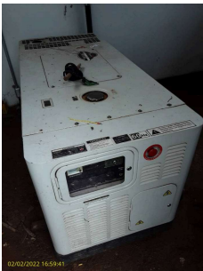
Foto 3 - Gerador da elevatória.
