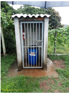
Foto 2 - Armazenamento de fluor para dosagem no poço.
