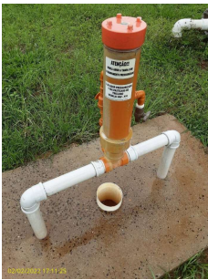
Foto 1 - Clorador do poço.
