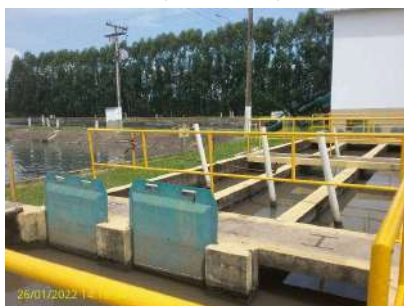
Foto 3 - Estrutura de entrada de esgoto bruto
