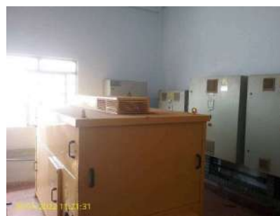
Foto 2 - Soprador da retrolavagem
