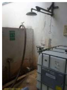
Foto 4 - Chuveiro de emergência
