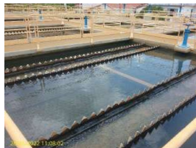
Foto 29 - Detalhe dos decantadores desnivelados
