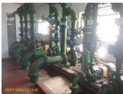
Foto 1 - Vista geral do bombeamento
