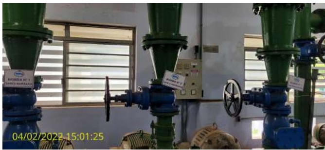
Foto 5 - Bombeamento Santa Bárbara
