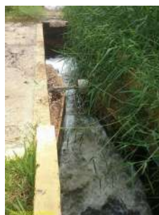
Foto 2 - Ausência de limpeza
