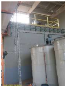
Foto 14 - Adensador de lodo
