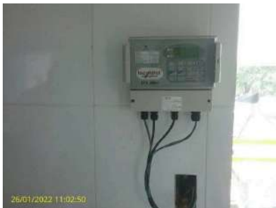
Foto 23 - macromedidor de vazão na entrada da ETA
