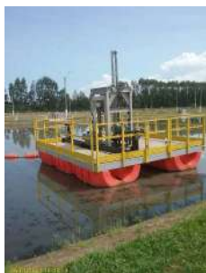
Foto 20 - Estação de captação e bombeamento de lodo
