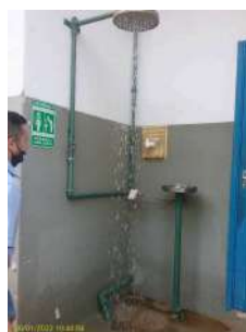
Foto 2 - Chuveiro de emergência
