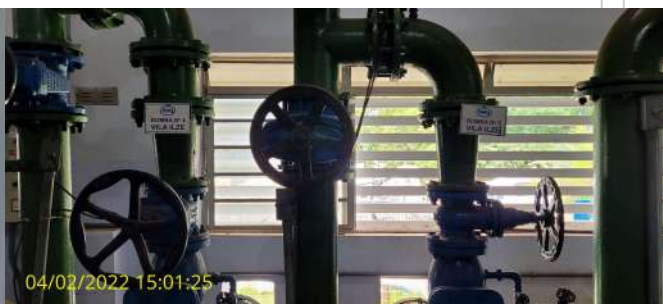
Foto 4 - Bombeamento Vila Ilze
