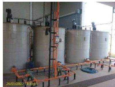
Foto 13 - Tanques de polímero
