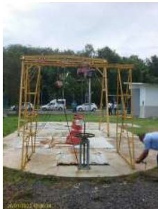
Foto 7 - Vista geral da EEEB
