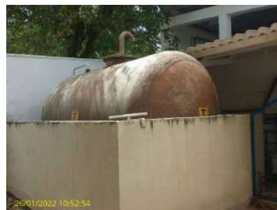
Foto 10 - Tanque de produto químico
