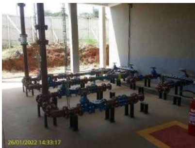
Foto 12 - Barrilete das bombas de lodo
