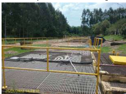
Foto 7 - Vista geral da EEEB
