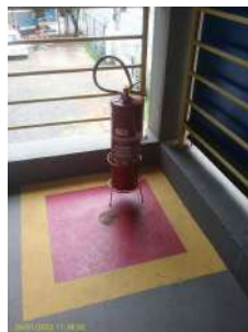
Foto 35 - Extintor de incêndio
