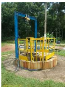
Foto 5 - Estação Elevatória de Esgoto Bruto
