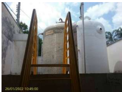
Foto 3 - Tanques de produtos químicos
