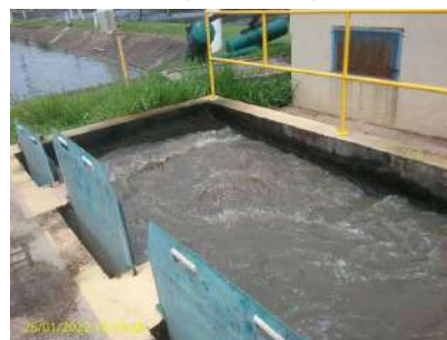
Foto 4 - Estrutura de entrada de esgoto bruto
