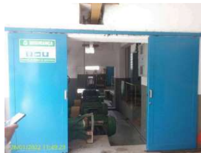
Foto 6 - Sala de bombas
