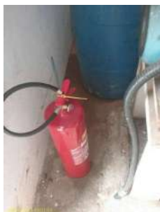
Foto 3 - Extintor de incêndio
