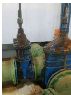
Foto 1 - Detalhe do vazamento nos registros
