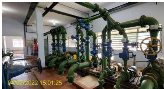
Foto 3 - Vista geral dos conjuntos de recalque
