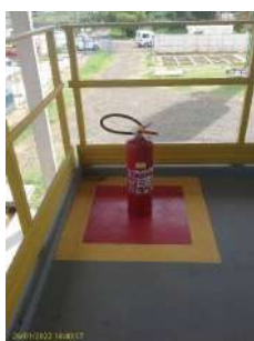
Foto 1 - Extintor de incêndio
