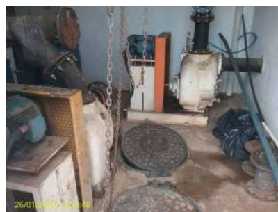
Foto 2 - Detalhe dos conjuntos moto-bomba
