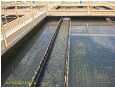
Foto 17 - Vista geral do decantador
