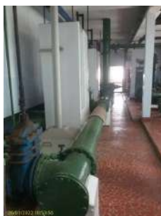
Foto 11 - Vista do bombeamento
