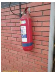
Foto 3 - Extintor de incêndio
