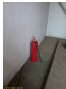
Foto 4 - Extintor de incêndio
