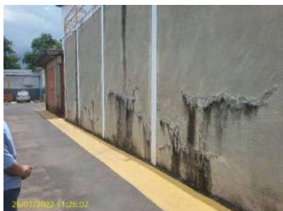
Foto 1 - Detalhe de infiltrações na parede do reservatório
