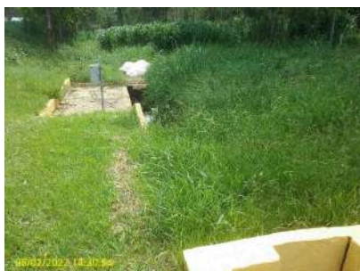
Foto 1 - Ausência de limpeza
