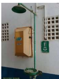
Foto 1 - Chuveiro de emergência
