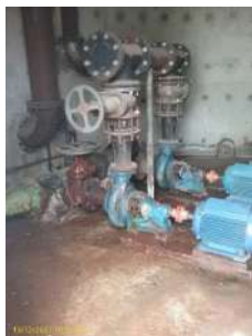
Foto 1 - Vazamento nas conexões
