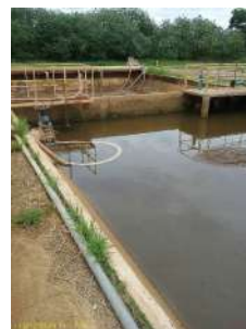
Foto 21 - Tanque ao fundo da ETA - efluente de lavagem dos filtros e decantadores
