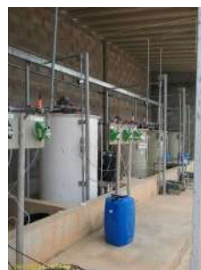
Foto 2 - Dosagem de produtos químicos
