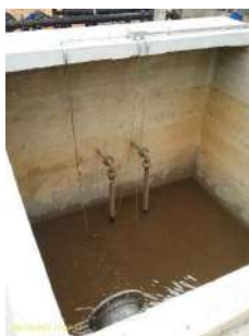
Foto 1 - Local sem guarda corpo
