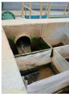
Foto 13 - Entrada de água bruta flocladores
