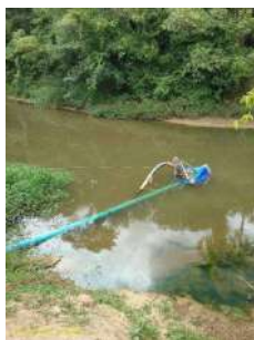
Foto 1 - Tomada de água- captação flutuante
