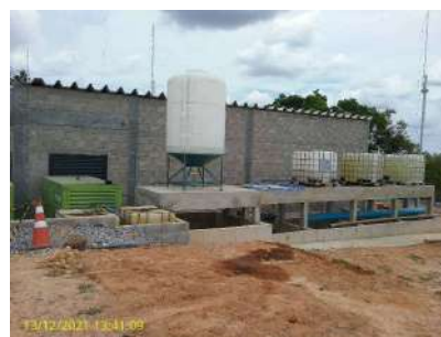
Foto 2 - Vista lateral ETA
