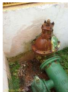
Foto 2 - Ponto com vazamento 2
