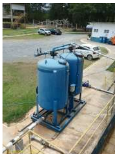
Foto 17 - Filtros de areia externos instalados para auxiliar os filtros da ETA - reduzir as paradas para lavagem
