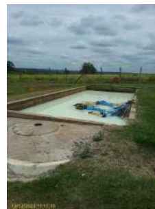
Foto 18 - Tanque de lodo
