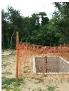
Foto 1 - Caixa de manobra sem guarda corpo
