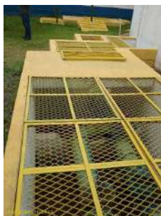
Foto 1 - Vista geral caixa de manobra
