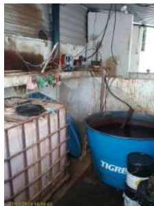
Foto 3 - Vista lateral da dosagem de produtos químicos
