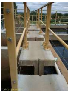
Foto 1 - Apesar da existência de guarda corpo, existem vãos no piso entre os tanques.
