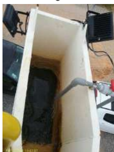
Foto 3 - Entrada de água bruta
