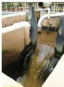
Foto 12 - Entrada água bruta
