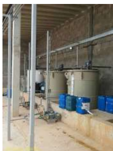
Foto 1 - Dosagem de produtos químicos
