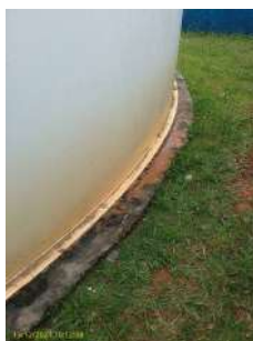
Foto 1 - Ponto com vazamento 1 - Ao redor do reservatório semi enterrado
