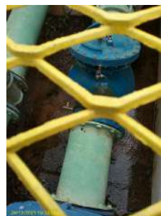
Foto 3 - Ponto com vazamento 3
