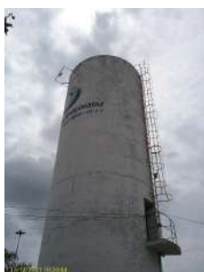
Foto 1 - Reservatório sem para-raios
