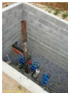
Foto 4 - Caixa de manobra
