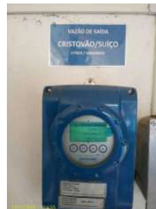
Foto 19 - Medidor de saída - Cristóvão
