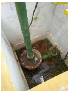
Foto 4 - Ponto com vazamento 4
