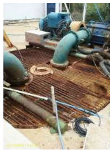
Foto 5 - Conjunto moto bomba
