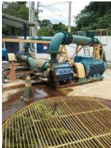
Foto 6 - Vista geral dos conjuntos moto bomba
