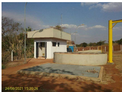
Foto 5 - Vista geral da elevatória Palmeiras II
