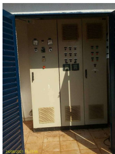
Foto 3 - Painel de comando e controle
