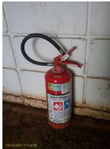
Foto 3 - Extintor de incêndio
