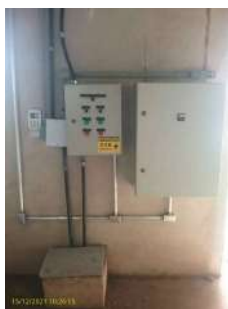
Foto 3 - Painel de comando e controle
