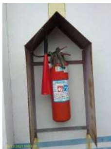
Foto 3 - Extintor de incêndio
