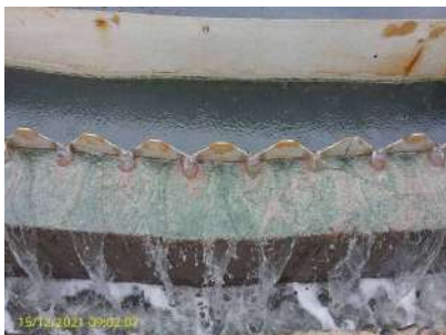
Foto 8 - Saída do esgoto tratado do flotador 1
