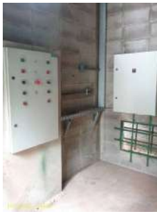
Foto 3 - Paineis de comando e controle
