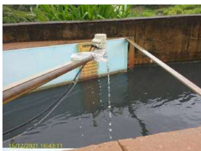
Foto 16 - Saída esgoto tratado
