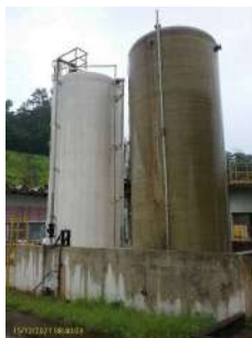
Foto 5 - Tanque armazenamento de produtos químicos
