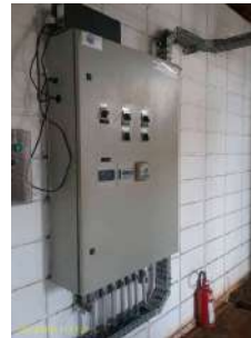
Foto 4 - Painel de comando e controle
