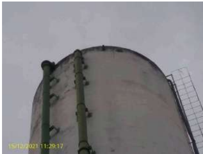
Foto 1 - Ausência de guarda-corpos
