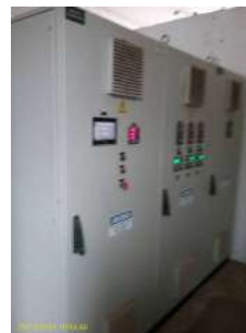
Foto 4 - Pannel de comando e controle
