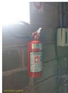
Foto 6 - Extintor de incêndio
