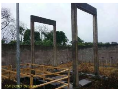
Foto 1 - Vista interior EEE Água Fria
