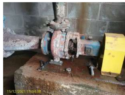
Foto 2 - Drenagem inadequada de água de lubrificação de gaxetas
