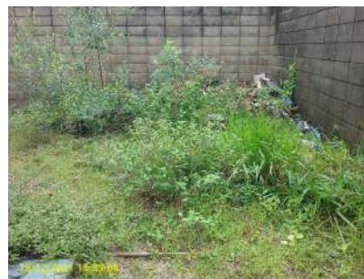
Foto 2 - Aspecto geral do local (mato alto e entulho)
