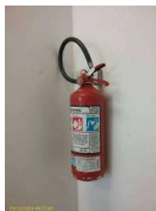
Foto 11 - Extintor de incêndio
