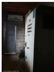
Foto 15 - Pannel de comando e controle, com ar condicionado
