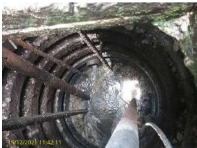
Foto 1 - Ausência de gradeamento grosseiro
