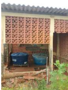
Foto 1 - Paredes danificadas da casa de dosagem de cloro e flúor
