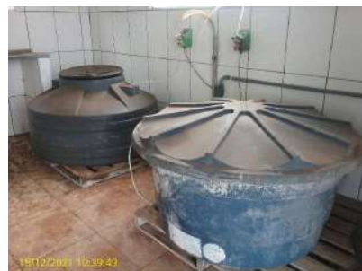
Foto 4 - Armazenamento de cloro e flúor
