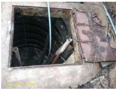
Foto 1 - Tampa de inspeção danificada
