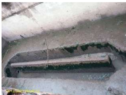
Foto 1 - Ausência de gradeamento grosseiro
