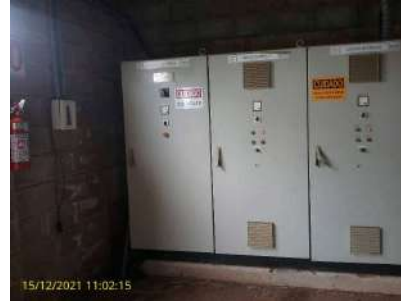
Foto 2 - Pannel de comando e controle
