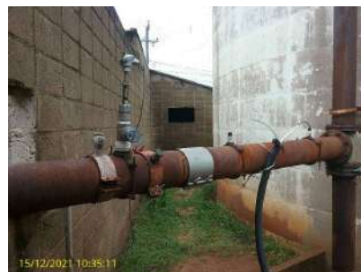
Foto 2 - Medidor de vazão
