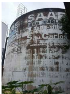
Foto 1 - Reservatório Antenor Garcia apoiado
