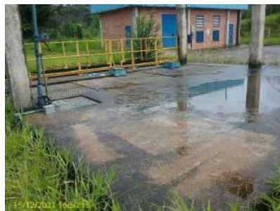
Foto 2 - Poço de sucção
