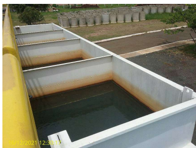
Foto 5 - Filtros fluxo descendente, 4 câmaras
