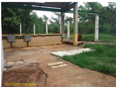
Foto 5 - Poço de sucção
