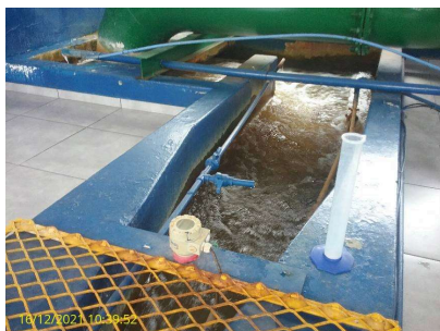
Foto 1 - Medidor de vazão
