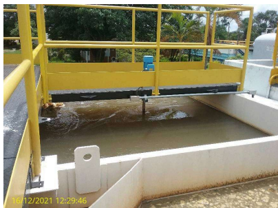
Foto 3 - Floculador mecânico com turbina de fluxo axial descendente, 4 câmaras
