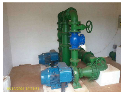
Foto 2 - Conjuntos motobomba (potência 60 CV)
