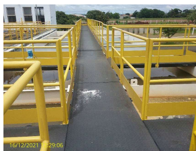
Foto 2 - Vista superior da ETA IV
