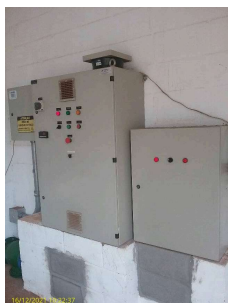
Foto 3 - Painel de comando e controle
