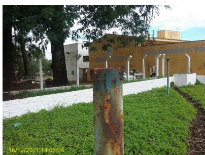
Foto 1 - Ausência de tela de proteção em algumas tubulações de ventilação
