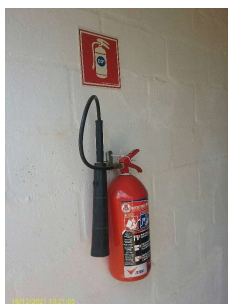
Foto 1 - Extintor de incêndio
