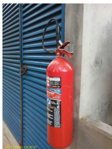
Foto 1 - Extintor de incêndio
