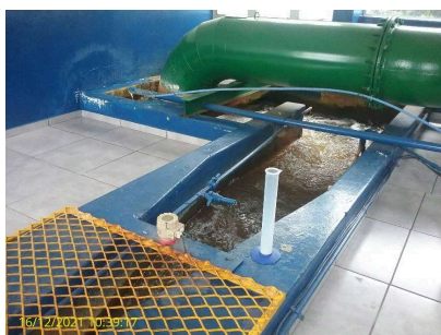
Foto 1 - Chegada de água bruta na ETA IV, II e III
