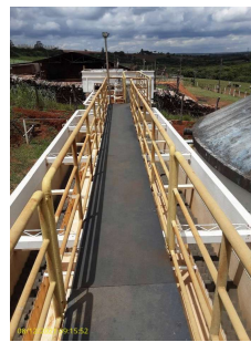
Foto 2 - Vista geral da ETA Compacta.
