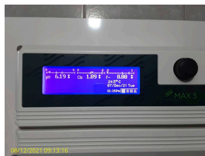
Foto 2 - Instrumento para monitoramento de pH, cloro e flúor.
