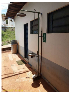
Foto 1 - Chuveiro de emergência.
