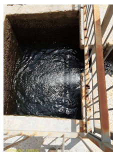
Foto 2 - Vista dos filtros.
