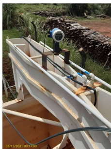
Foto 1 - Macromedidor de entrada da ETA.
