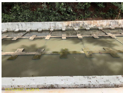
Foto 9 - Saída da ETE.
