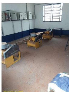
Foto 1 - Bombas em funcionamento, sendo uma reserva.
