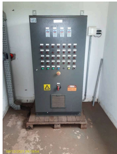
Foto 3 - Painel de controle da ETA Compacta.
