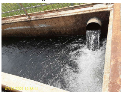
Foto 3 - Chegada da água bruta.
