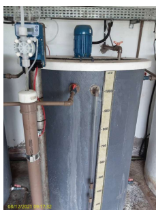
Foto 1 - Estocagem de produtos químicos.
