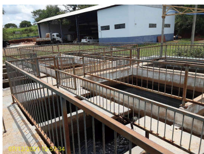
Foto 1 - Vista geral da ETA Convencional.
