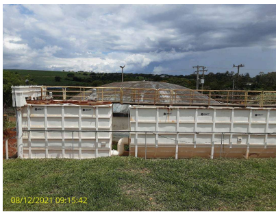
Foto 1 - Vista geral da ETA Compacta.
