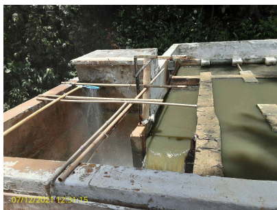
Foto 1 - Macromedidor de saída instalado.
