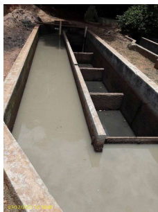
Foto 1 - Chegada do esgoto bruto.
