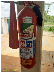
Foto 1 - Extintor de incêndio junto à central de telemetria.
