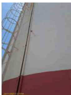
Foto 1 - Para-raio sem condutor de descida.
