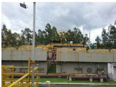
Foto 12 - Vista dos reatores anaeróbios
