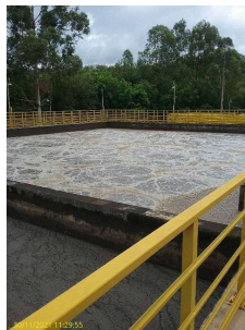
Foto 10 - Tanque de aeração
