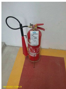
Foto 1 - Extintor da unidade
