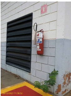
Foto 2 - Extintor de incêndio disponível na unidade
