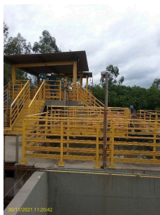
Foto 7 - Vista geral do tratamento preliminar
