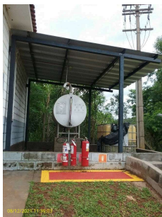
Foto 3 - Extintores de incêndio disponíveis na unidade
