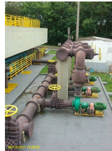
Foto 21 - Recirculação do lodo
