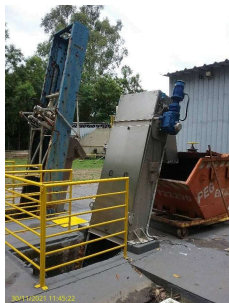
Foto 14 - Vista geral do gradeamento grosseiro - Está prevista a troca da outra grade mecanizada
