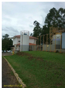
Foto 8 - Tanque alcalinizante - hidróxido de cálcio
