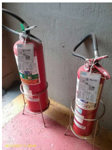
Foto 1 - Extintores de incêndio disponíveis na unidade
