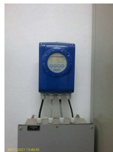
Foto 2 - Medidor de vazão
