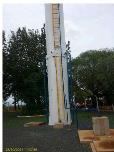
Foto 1 - Ausência de guarda-corpo no início da escada de acesso
