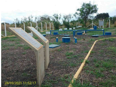
Foto 1 - ETE compacta Assentamento Bela Vista
