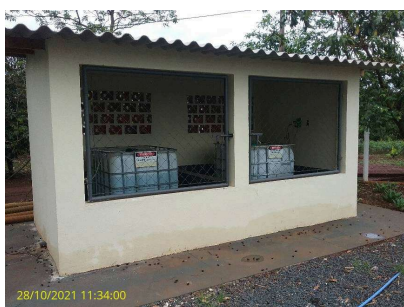
Foto 1 - Sistema de armazenamento de cloro e flúor
