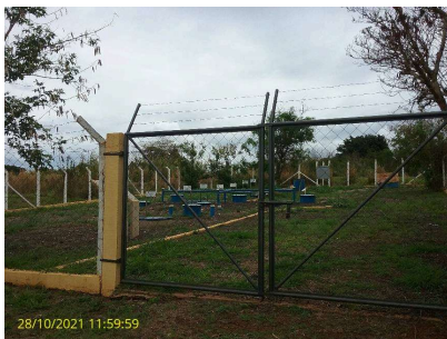
Foto 3 - Vista externa da ETA compacta Assentamento Bela Vista
