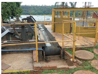
Foto 1 - Ausência de conservação e base solta.
