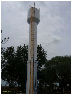
Foto 1 - Reservatório Bela Vista
