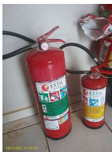
Foto 1 - Extintor de incêndio
