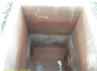
Foto 11 - Chegada água de lavagem dos filtros e decantadores
