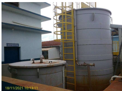
Foto 9 - Dosagem de cloreto ferrico
