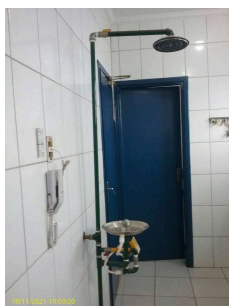
Foto 1 - Chuveiro de emergência do laboratório
