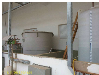
Foto 10 - Dosagem de flúor e cloro
