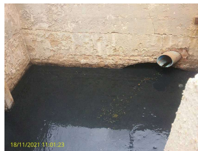
Foto 2 - Chegada de esgoto bruto
