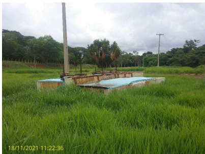
Foto 11 - Caixas de distribuição efluentes DAFA's para lagoas
