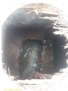
Foto 15 - Interceptor localizado na Av. Carlos Berchieli
