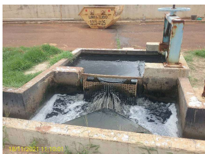
Foto 7 - Caixa de distribuição de vazão
