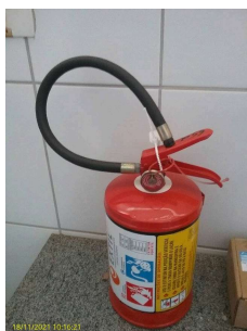
Foto 1 - Extintor de incêndio
