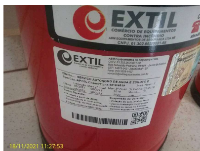
Foto 1 - Validade do extintor
