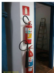
Foto 2 - Extintor de incêndio
