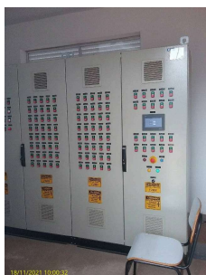
Foto 7 - Painel de comando e controle
