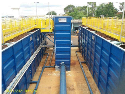
Foto 5 - Vista dos decantadores
