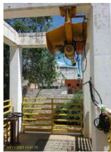
Foto 4 - Poço com gradeamento da elevatória
