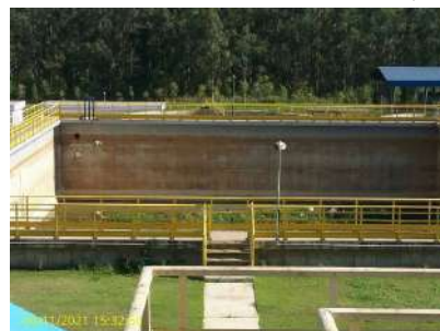
Foto 15 - Reator sem operação por problema estrutural
