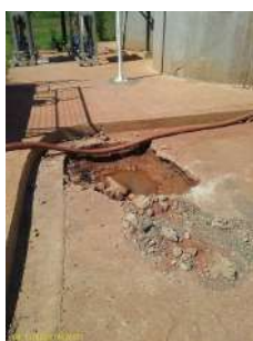
Foto 1 - Vazamento próximo ao gradeamento
