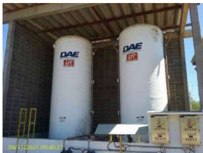
Foto 10 - Tanques de hipoclorito para desinfecção do efluente
