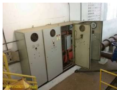
Foto 2 - Painel de controle dos conjuntos motobomba
