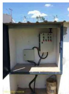
Foto 2 - Painel de controle dos conjuntos motobomba
