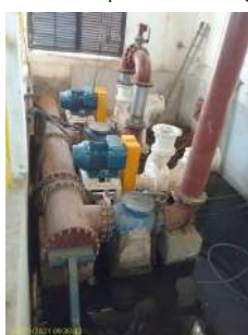
Foto 3 - Vazamento de efluente na elevatória
