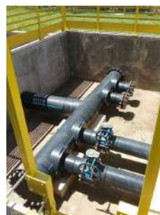
Foto 2 - Barrilete do reservatório
