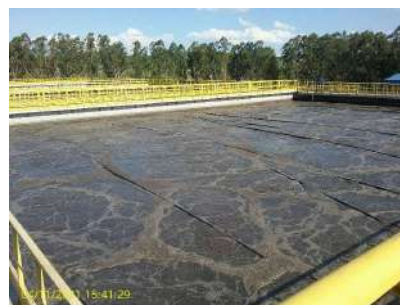
Foto 19 - Reator em operação
