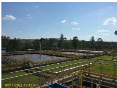
Foto 14 - Reatores do sistema de lodos ativados
