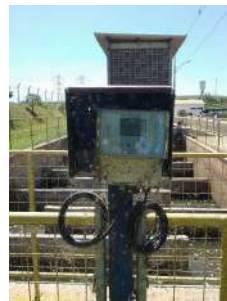
Foto 19 - Painel do macromedidor de saída
