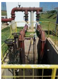
Foto 13 - Detalhe do tanque de lodo
