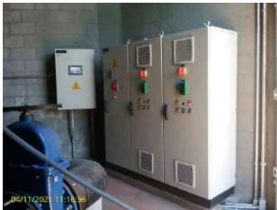
Foto 1 - Painel de controle dos conjuntos motobomba
