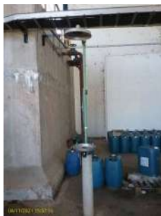
Foto 27 - Chuveiro de emergência
