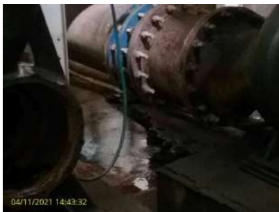
Foto 1 - Detalhe do vazamento na tubulação de sucção
