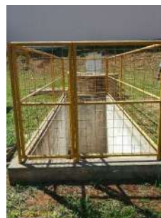
Foto 4 - Guarda corpo do gradeamento e desarenador
