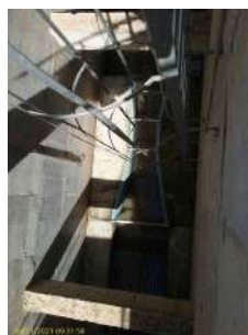
Foto 3 - Detalhe da Calha Parshall
