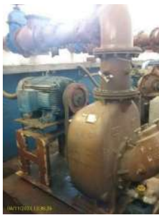
Foto 3 - Detalhe do conjunto motobomba
