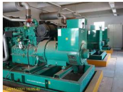
Foto 34 - Geradores da ETE
