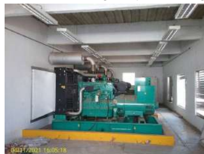
Foto 33 - Sala dos geradores
