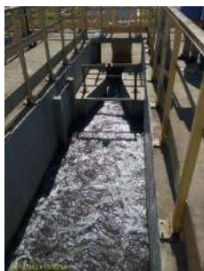
Foto 11 - Medidor de vazão de entrada ultrasônico e calha Parshall
