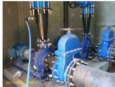
Foto 2 - Conjuntos motobomba e tubulações de sucção e recalque
