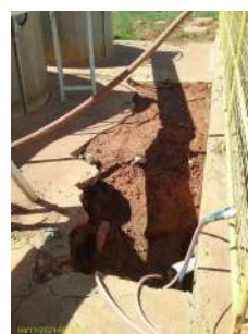
Foto 2 - Vazamento próximo ao gradeamento
