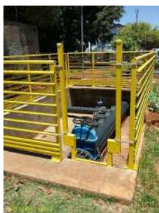
Foto 3 - Barrilete do reservatório
