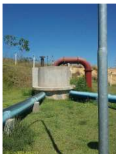
Foto 15 - Entrada do efluente para distribuição no reator
