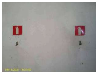
Foto 17 - Ausência de extintores de incêndio na sala dos sopradores
