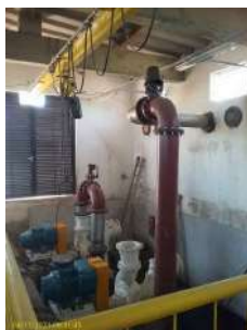
Foto 1 - Conjunto motobomba da elevatória
