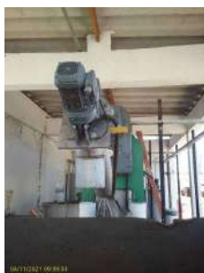
Foto 8 - Filtro prensa para desidratação do lodo
