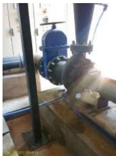
Foto 1 - Detalhe da drenagem inadequada
