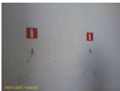
Foto 1 - Sem extintor de incêndio próximo aos conjuntos motobomba
