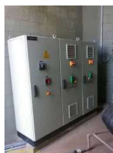
Foto 2 - Pannel de controle dos conjuntos motobomba
