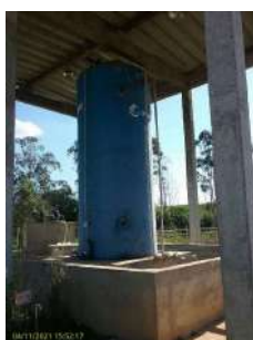
Foto 22 - Tanque de hipoclorito
