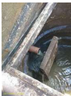
Foto 3 - Tubulação de entrada do efluente
