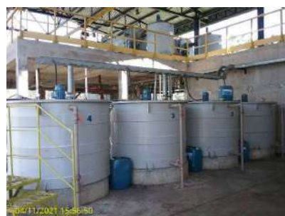
Foto 26 - Tanques de preparação de polímero para adensamento do lodo
