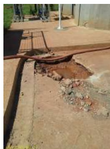
Foto 5 - Detalhe do vazamento no piso da ETE, próximo ao tratamento preliminar
