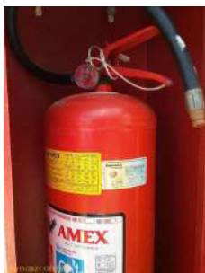
Foto 1 - Detalhe do extintor de incêndio
