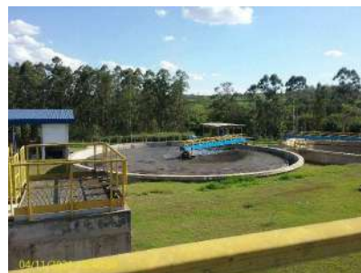
Foto 21 - Decantador do sistema de lodos ativados
