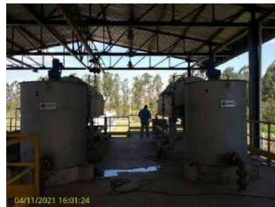
Foto 30 - Adensadores de lodo
