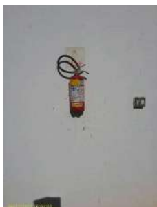
Foto 32 - Extintor de incêndio vencido (cabine primária)
