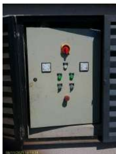
Foto 5 - Painel de controle dos conjuntos motobomba
