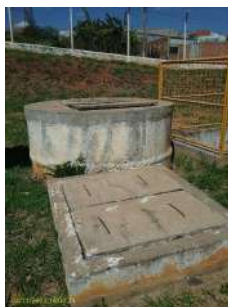
Foto 3 - Poço de entrada do efluente
