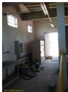
Foto 7 - Painel de controle dos conjuntos motobomba da elevatória
