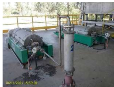
Foto 28 - Centrifugas para desidratação do lodo
