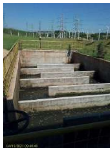
Foto 11 - Tanque de contato
