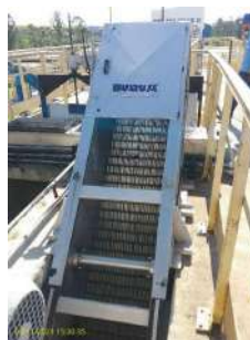
Foto 10 - Gradeamento do tratamento preliminar
