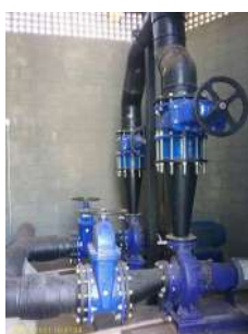
Foto 1 - Conjuntos motobomba e tubulações de sucção e recalque
