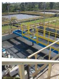
Foto 13 - Desarenador no tratamento primário
