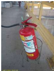
Foto 29 - Extintor de incêndio da estação de tratamento de lodo
