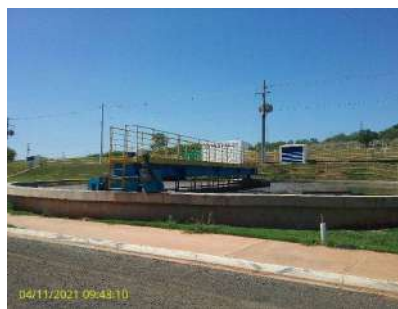
Foto 14 - Decantador após valo de oxidação
