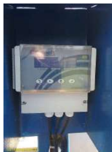
Foto 12 - Painel do medidor ultrassônico de vazão
