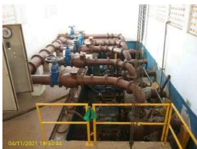
Foto 1 - Conjuntos motobomba da elevatória (4 bombas de 100 CV cada mais bomba reserva)
