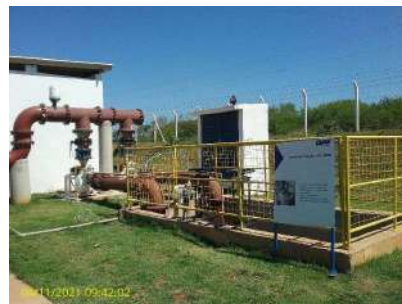
Foto 12 - Tanque de sucção do lodo
