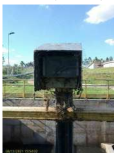
Foto 24 - Painel do macromedidor de vazão de saída
