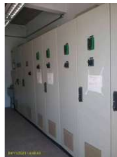
Foto 6 - Painel de controle dos conjuntos motobomba
