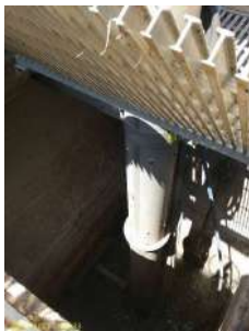
Foto 5 - Poço de sucção do esgoto
