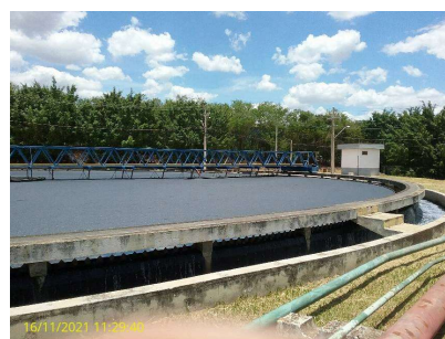
Foto 8 - Um dos dois decantadores primários
