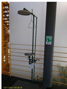
Foto 1 - Chuveiro de emergência
