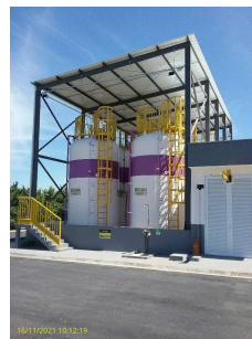
Foto 4 - Sistema de desinfecção com hipoclorito de sódio
