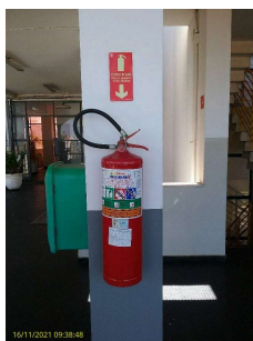
Foto 1 - Extintor de incêndio
