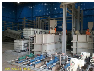
Foto 11 - Tratamento de lodo
