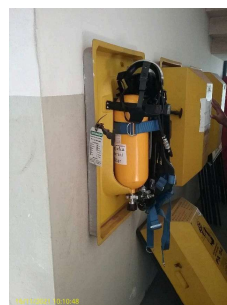
Foto 2 - Equipamento para contenção de vazamento
