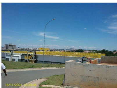
Foto 1 - Estação de tratamento de lodo
