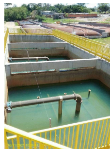
Foto 3 - Estação de tratamento de lodo
