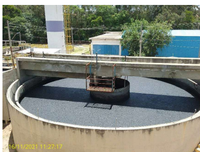
Foto 7 - Adensador do lodo do decantador primário
