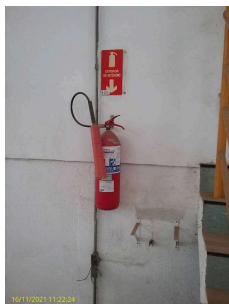
Foto 1 - Extintor de incêndio
