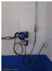
Foto 2 - Display do medidor de vazão
