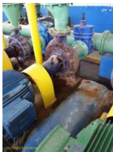
Foto 1 - Vazamento nas gaxetas das bombas atuais a desativar, a ser resolvido com a elevatória recém construída
