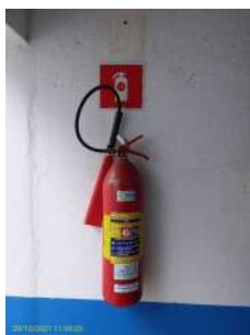
Foto 1 - Extintor de incêndio
