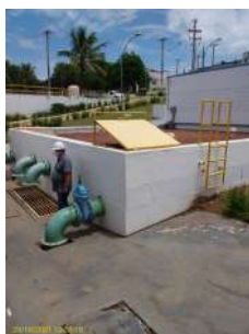
Foto 1 - Reservatório e tanque de contato 300 m3 e tubulações de entrada e extravazao
