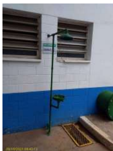
Foto 3 - Chuveiro de emergência
