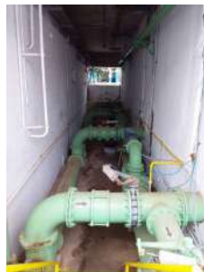
Foto 17 - Saída dos filtros
