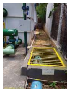
Foto 2 - Chegada da água bruta e macromedicação
