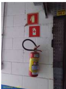
Foto 1 - Extintor de incêndio
