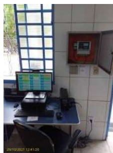
Foto 2 - Display do medidor de vazão e sistema de controle operacional
