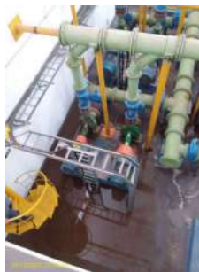
Foto 2 - Bombas para Itapeva
