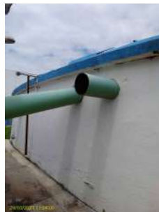
Foto 2 - Extravazador sem telas de proteção
