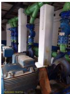
Foto 1 - 2 bombas a direita
