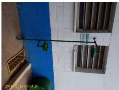
Foto 1 - Chuveiro de emergência
