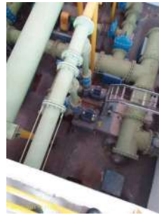
Foto 2 - Bombas para retrolavagem
