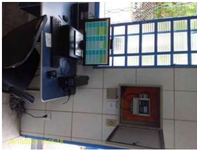
Foto 1 - Display do medidor de vazão
