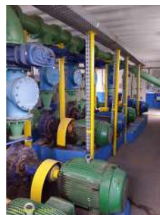
Foto 2 - Aspecto geral das bombas
