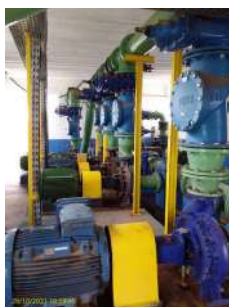
Foto 1 - Aspecto geral das bombas
