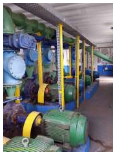
Foto 2 - Aspecto geral das bombas atuais (a desativar)
