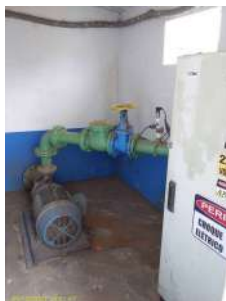
Foto 1 - Aspecto geral das bombas
