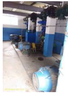
Foto 4 - Conjuntos de recalque
