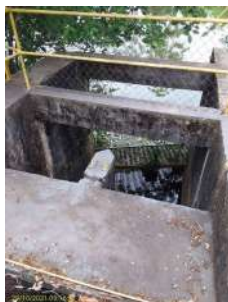
Foto 1 - Tomada de água e gradeamento
