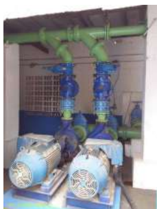
Foto 1 - Aspecto geral das bombas
