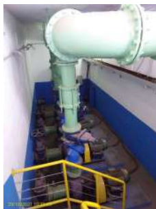
Foto 1 - 4 bombas de 25cv. Também usa para lavar filtros. Transfere de R2 para R1
