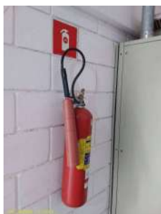
Foto 1 - Extintor de incêndio
