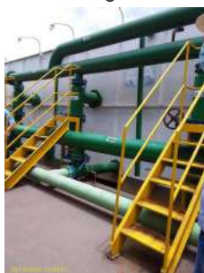
Foto 3 - Saída dos filtros
