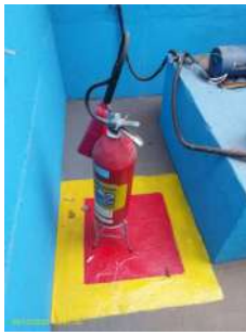
Foto 1 - Extintor de incêndio
