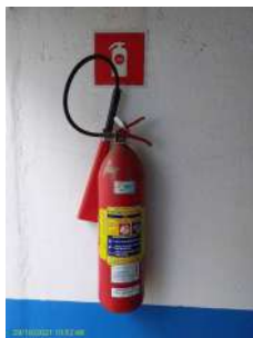
Foto 1 - Extintor de incêndio
