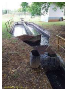
Foto 3 - Tratamento preliminar: gradeamento e caixa de areia
