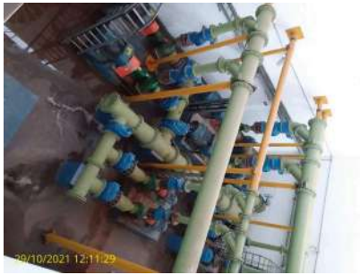
Foto 1 - Elevatórias da ETA Votocel para Votopel, São João, Itapeva e retrolavagem
