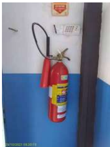
Foto 1 - Extintor de incêndio
