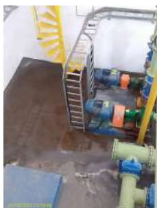
Foto 1 - Vazamentos em gaxetas
