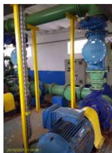
Foto 2 - Aspecto geral das bombas
