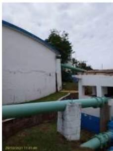
Foto 1 - Extravazador sem telas de proteção
