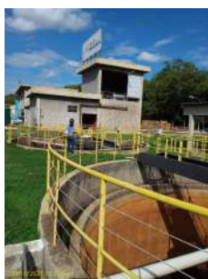
Foto 14 - Decantadores e centrífugas de lodo
