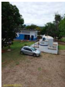
Foto 1 - Tanques de armazenamento com bacias de contenção
