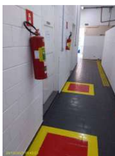
Foto 1 - Extintor de incêndio
