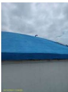
Foto 3 - Ventilação sem telas de proteção
