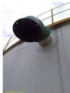
Foto 2 - Extravazador sem telas de proteção
