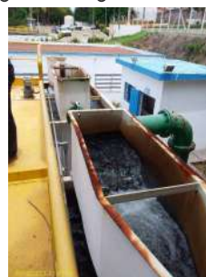
Foto 4 - Chegada da água bruta
