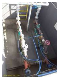
Foto 15 - Bombas de lodo
