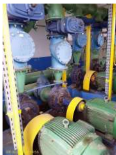
Foto 1 - Aspecto geral das bombas
