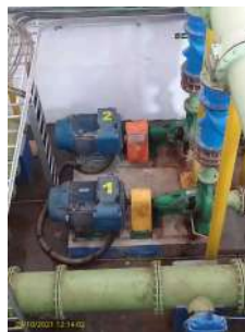
Foto 2 - Bombas para São João
