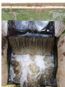
Foto 12 - Saída da lagoa aerada
