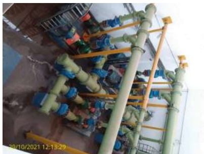
Foto 1 - Elevatórias da ETA Votocel para Votopel, São João, Itapeva e retrolavagem
