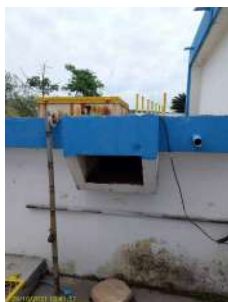
Foto 1 - Extravazador sem telas de proteção
