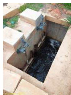
Foto 13 - Saída da lagoa aerada, com by pass para lagoa de polimento se necessário
