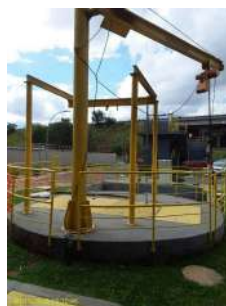
Foto 4 - Elevatória de entrada
