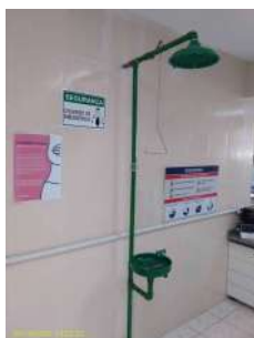
Foto 1 - Chuveiro de emergência
