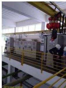
Foto 3 - Painéis elétricos, talha e monovia
