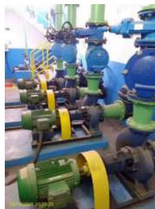
Foto 2 - Aspecto geral das bombas
