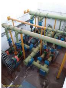
Foto 1 - Elevatórias da ETA Votocel para Votopel, São João, Itapeva e retrolavagem
