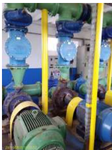
Foto 1 - Aspecto geral das bombas atuais (a desativar)
