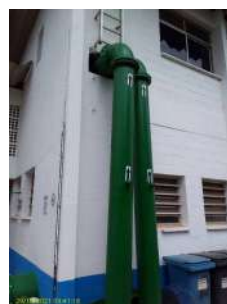
Foto 2 - Chegada da água bruta
