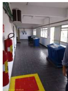
Foto 4 - Sala de comando de filtros
