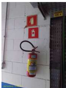
Foto 1 - Extintor de incêndio
