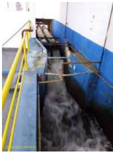
Foto 5 - Chegada da água bruta e aplicação de produtos químicos
