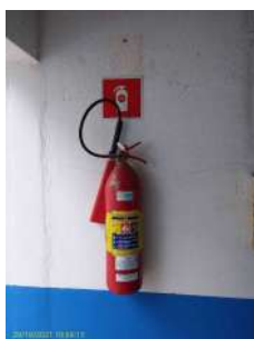
Foto 1 - Extintor de incêndio
