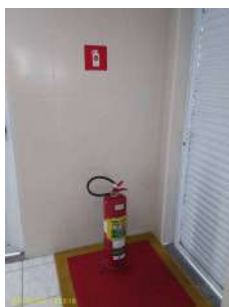
Foto 1 - Extintor de incêndio
