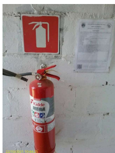
Foto 1 - Extintor de incêndio
