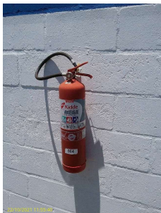
Foto 1 - Extintor de incêndio
