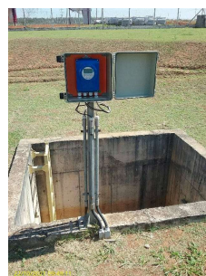
Foto 2 - Macromedidor na outra chegada
