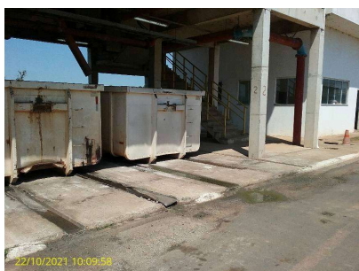
Foto 1 - Drenagem inadequada de esgoto área do tratamento de lodo
