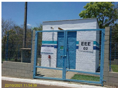
Foto 1 - Vista geral da EEEB
