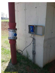
Foto 1 - Macromedidor em 1 das entradas
