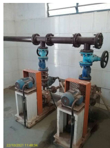
Foto 2 - Interior da EEEB
