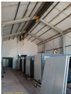
Foto 1 - Sala de sopradores. No momento da visita, 2 sopradores estavam em manutenção, 2 em operação e 1 reserva
