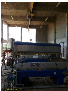
Foto 1 - Adensadores e centrifugas
