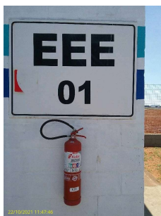
Foto 1 - Extintor de incêndio
