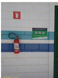
Foto 1 - Extintor de incêndio
