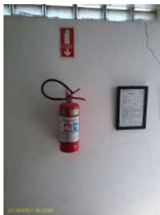
Foto 1 - Extintor de incêndio
