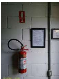
Foto 1 - Extintor de incêndio
