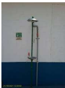
Foto 1 - Chuveiro de emergência
