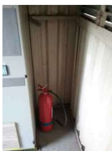
Foto 1 - Extintor de incêndio
