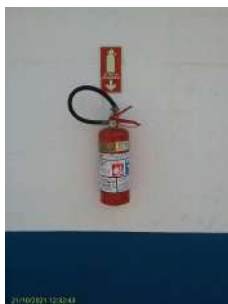
Foto 1 - Extintor de incêndio
