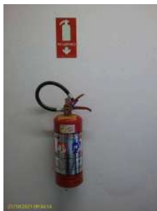
Foto 1 - Extintor de incêndio
