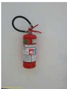
Foto 1 - Extintor de incêndio
