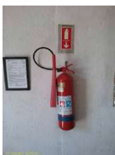
Foto 1 - Extintor de incêndio
