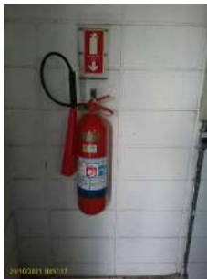
Foto 1 - Extintor de incêndio
