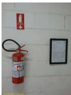
Foto 1 - Extintor de incêndio
