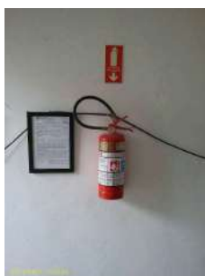
Foto 1 - Extintor de incêndio
