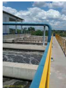
Foto 4 - Tanque de modos ativados. Todo o efluente passa por UASB, e 100 litros por segundo são tratados no tanque de lodo ativado. O excesso de vazão vai para os filtros anaeróbios. No momento da inspeção, a vazão de entrada era de 130 litros por segundo.
