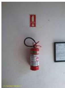
Foto 1 - Extintor de incêndio
