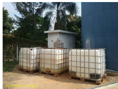
Foto 3 - Bombonas de cloro e fluor para cloração e fluoretação da água
