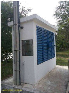
Foto 3 - Abrigo do painel de controle
