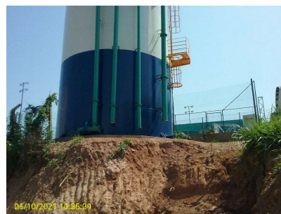
Foto 2 - Acesso ao reservatório ainda não realizado
