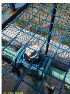
Foto 1 - Macromedidor do poço
