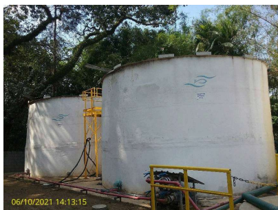
Foto 3 - Tanques de aeração
