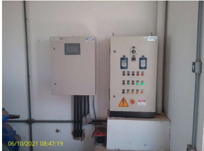
Foto 1 - Painel de controle dos conjuntos motobomba
