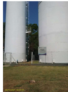
Foto 4 - Placa de identificação do reservatório
