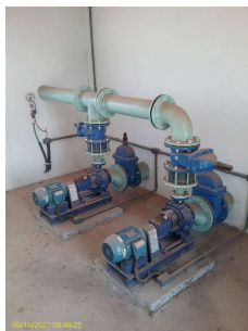
Foto 1 - A elevatória possui dois conjuntos motobomba
