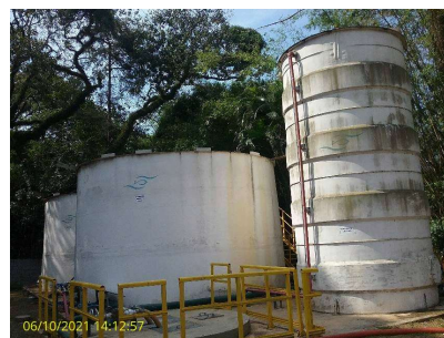
Foto 2 - Tanque de lodo à direita e tanque de aeração à esquerda
