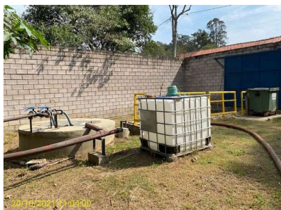
Foto 1 - Elevatória com acesso para manutenção
