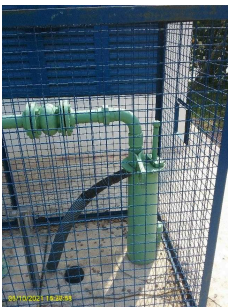
Foto 1 - Tubo de medição de nível
