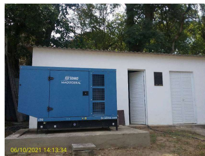
Foto 4 - Gerador e laboratório ao fundo
