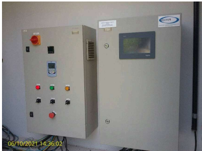
Foto 1 - Painel de controle do conjunto motobomba
