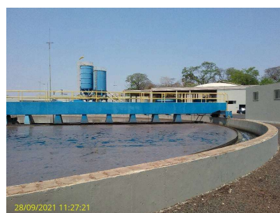
Foto 4 - Um dos decantadores
