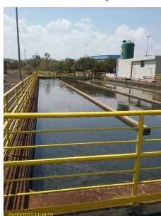
Foto 5 - Tanque de contato
