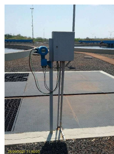
Foto 2 - Macromedidor da saída. Não estava funcionando no momento da fiscalização. Concessionária alega que o medidor é do Parceiro Público.
