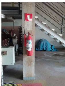
Foto 1 - Extintor de incêndio
