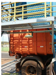
Foto 1 - Chuveiro de emergência
