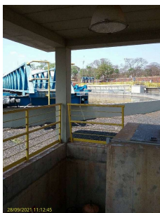
Foto 1 - Guarda-corpo não está fixado
