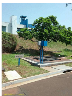
Foto 1 - Macromedidor da entrada
