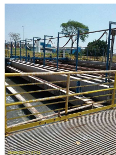
Foto 2 - Guarda-corpo do tratamento preliminar em estado de oxidação
