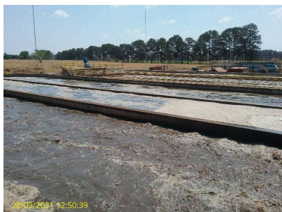
Foto 3 - Um dos tanques de aeração
