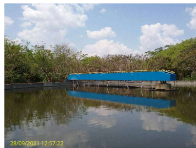
Foto 4 - Um dos decantadores
