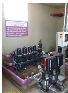
Foto 6 - Geração de água de reuso não potável
