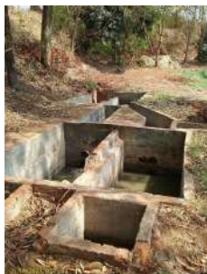
Foto 1 - Chegada do esgoto. Vazão estima de 28 L/s. Reformas previstas para 2022
