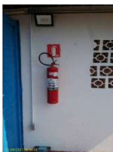
Foto 1 - Extintor de incêndio
