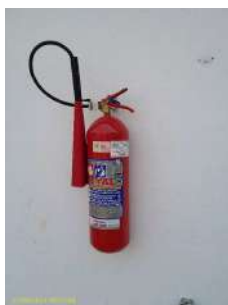
Foto 1 - Extintor de incêndio
