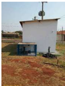
Foto 1 - EEA pressuriza para próprio bairro Bela Vista
