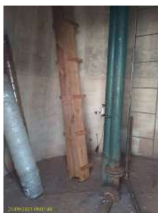
Foto 1 - Bomba reserva dos poços 1 e 4
