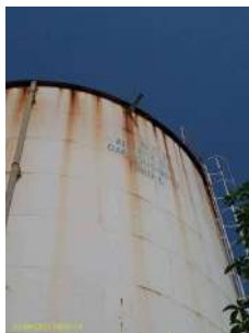
Foto 1 - Sem tela de proteção na tubulação de ventilação
