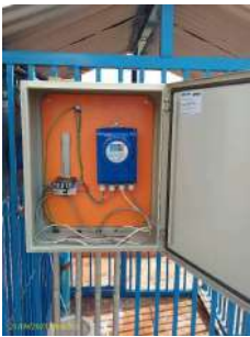
Foto 1 - Medidor de nível, mas ainda não está ainda enviando sinal para CCO
