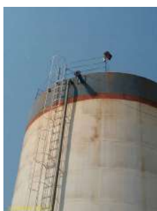
Foto 1 - Local sem tela de proteção
