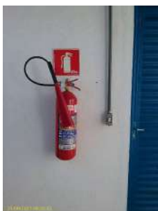
Foto 1 - Extintor de incêndio
