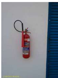
Foto 1 - Extintor de incêndio
