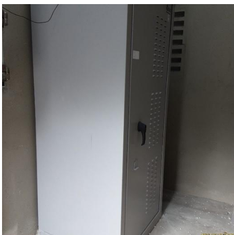
Foto 7 - EEE Botujuru IIA: Novo painel elétrico.
