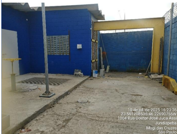
Foto 11 - EEE Andiroba: Vista geral da elevatória e da edificação que abriga os equipamentos elétricos, algumas melhorias já foram realizadas.
