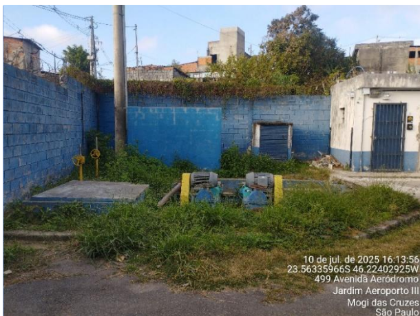
Foto 9 - EEE Oceania: Vista geral da elevatória.
