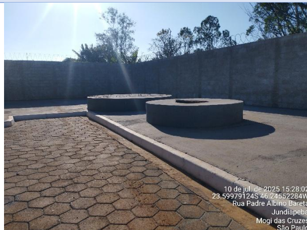
Foto 2 - EEE 1.1: Vista geral da elevatória.
