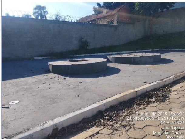
Foto 7 - EEE 2.1: Vista geral da elevatória.
