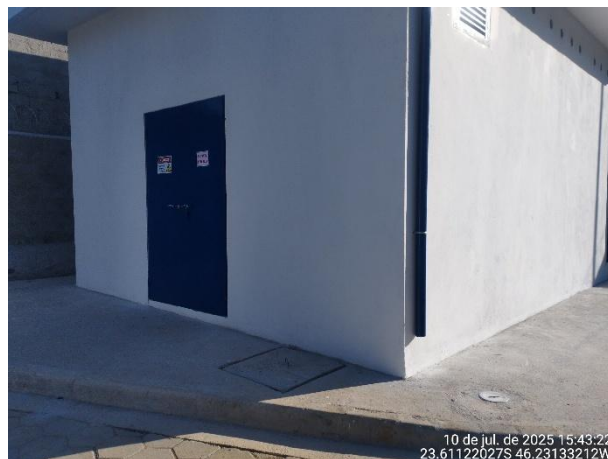
Foto 4 - EEE 4.1: Edificação para abrigo de equipamentos e painéis elétricos.
