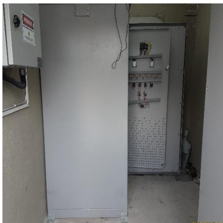
Foto 3 - EEE Botujuru I: Novo painel elétrico.
