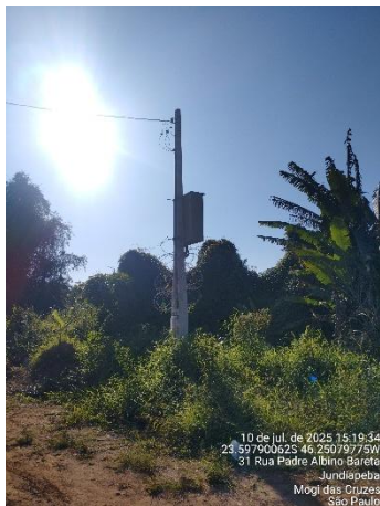
Foto 5 - EEE 1.2: Não há edificação de apoio para esta elevatória, o painel elétrico das bombas está instalado junto a um poste localizado na calçada.
