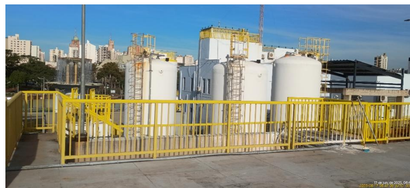
Foto 4 – Guarda-corpos e escadas marinheiro instalados nos tanques de armazenamento de produtos químicos da ETA Palácio das Águas.
