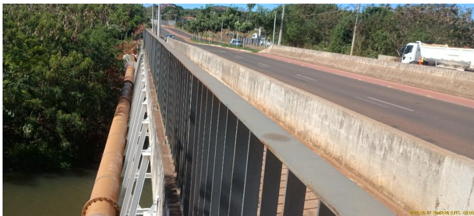
Foto 3 - Trecho do interceptor na ponte do Córrego dos Macacos, na Est. Vicinal Vicente Polachini.
