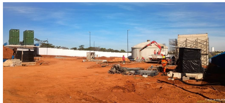
Foto 4 – Vista geral da área operacional do PTG11.
