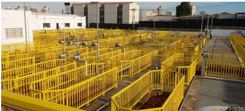
Foto 1 – Guarda-corpos instalados nas unidades de tratamento da ETA Palácio das Águas.
