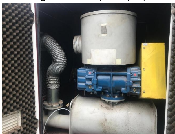
Figura TEC 9 – Soprador (ETE)
