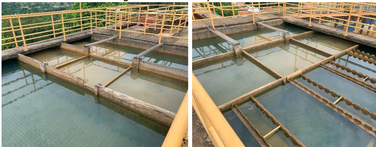
Figura TEC 3 – Otimização da ETA III
