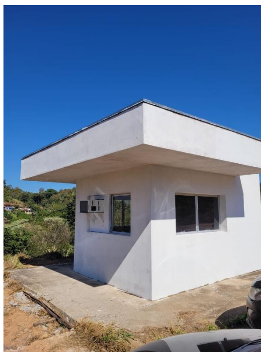
Figura TEC 6 - Vista da sala de operação da nova ETE
