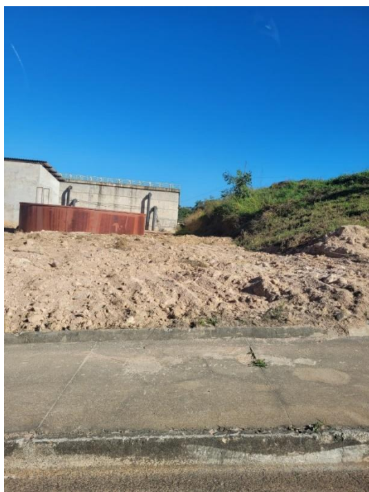
Figura TEC 7 - Vista da nova ETE
