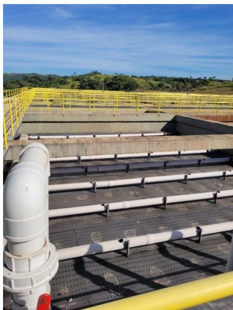
Figura TEC 3 - Tanques de efluentes da nova ETE
