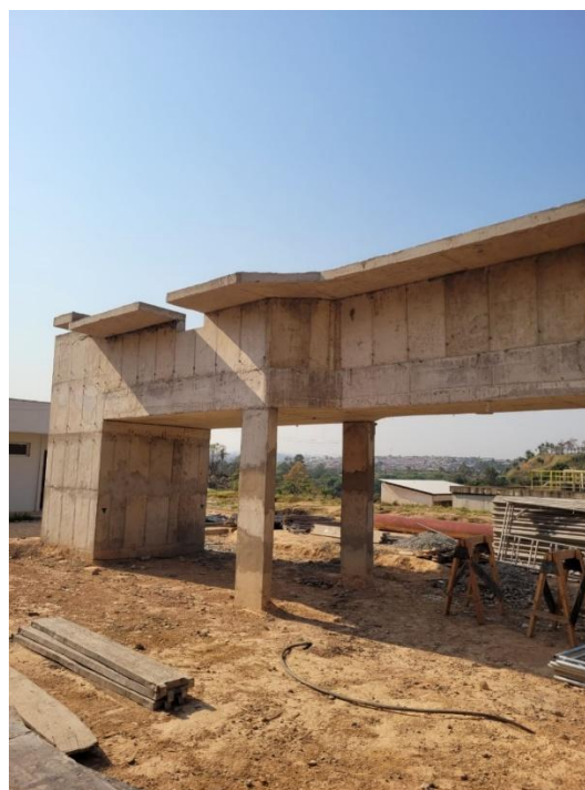
Figura TEC 8 - Vista da nova ETE
