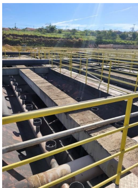
Figura TEC 4 - Tanques de efluentes da nova ETE
