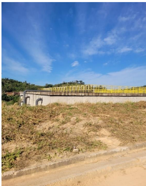
Figura TEC 1 – Vista da nova ETE
