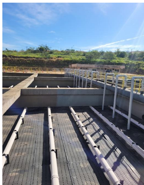
Figura TEC 2 – Tanques de efluentes da nova ETE
