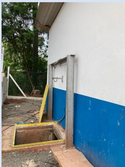
Elevatória dos Ferroviários
