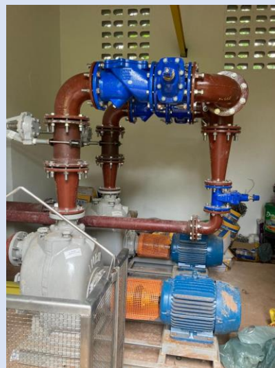
Vista interna da Elevatória – Motores/ Bombas/ conexões e demais materiais fornecidos pelo SAAE – Mão de Obra para instalações elétricas/ mecânicas e civis pela SESAMM
