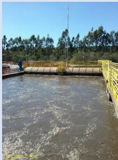
Tanque com aeração orbal tipo carrossel
