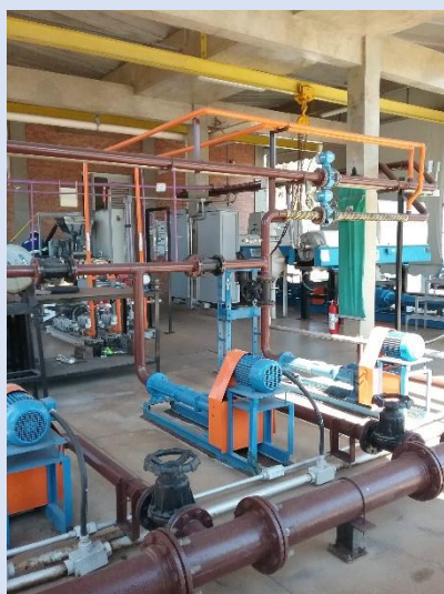
Vista geral da centrífuga de lodo
