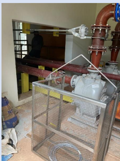
Vista interna - Elevatória dos Ferroviários
