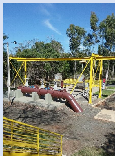
Vista geral Estação Elevatória Mogi Mirim
