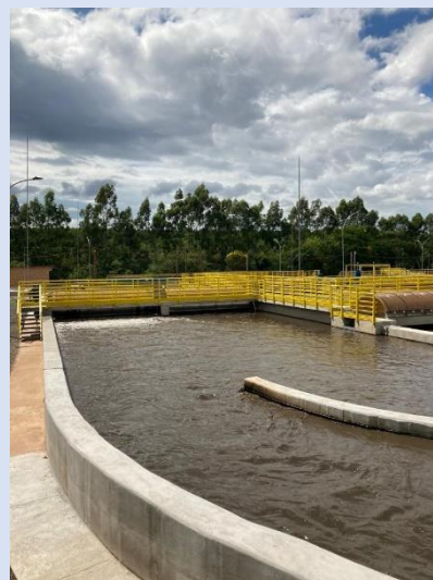
Novo reator biológico em operação
