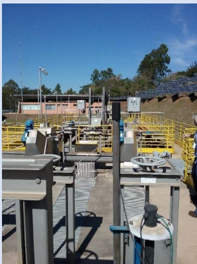
Tratamento preliminar – Gradeamento fino e desarenadores
