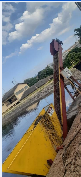
Proteção das partes móveis das roscas parafuso para cumprimento da NR12 Fonte: Fornecido pela CSJ
