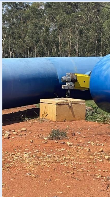
Proteção de parte móvel para cumprimento da NR12 em visita no dia 31/10/2024
