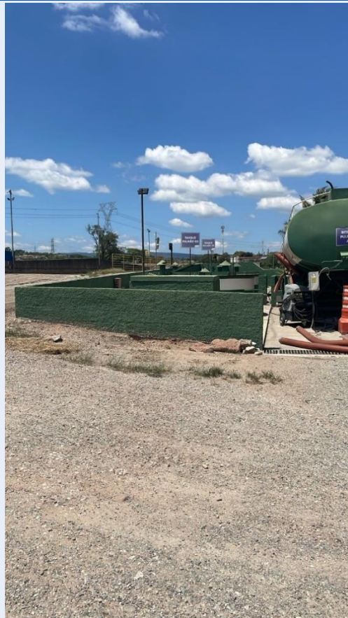
Tanques de recebimento do EvC em visita no dia 31/10/2024
