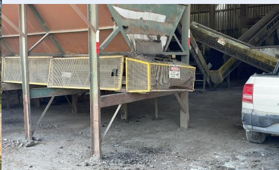
Proteção de parte móvel para cumprimento da NR12 em visita no dia 31/10/2024
