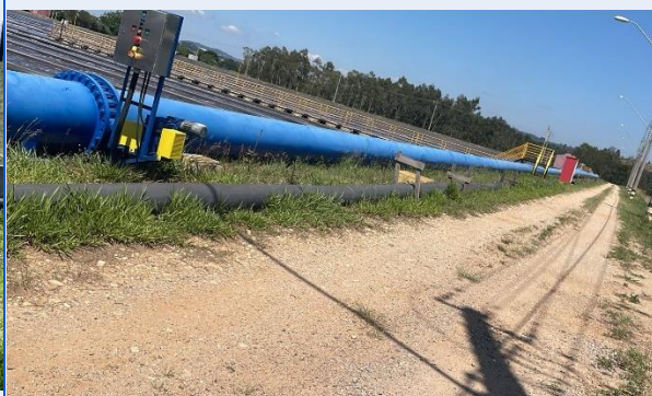
Tubulação cinza utilizada nos testes de Retorno de lodo em visita no dia 31/10/2024
