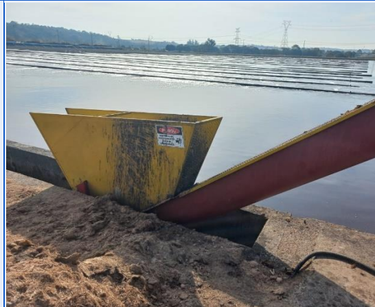
Proteção das partes móveis das roscas parafuso para cumprimento da NR12 Fonte: Fornecido pela CSJ
