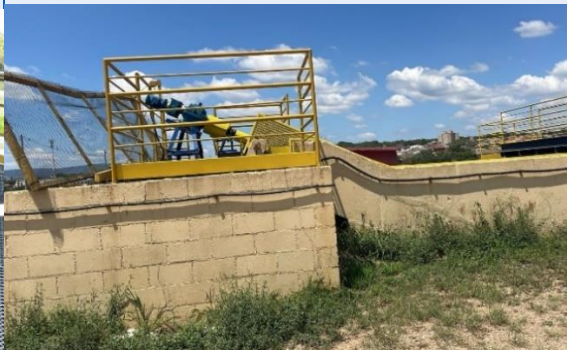
Guarda-corpo e proteção da parte móvel para cumprimento da NR12 em visita no dia 31/10/2024
