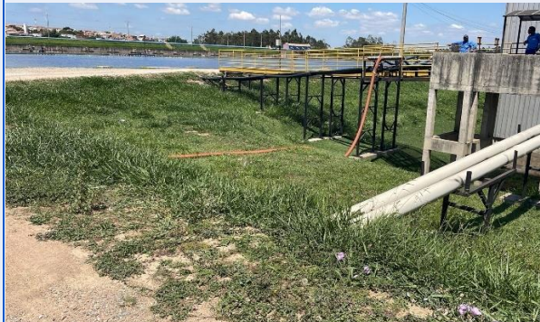
Bombas utilizadas nos testes de Retorno de lodo em visita no dia 31/10/2024
