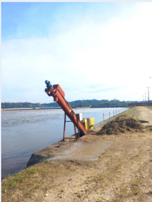
Proteção das partes móveis das roscas parafuso para cumprimento da NR12 Fonte: Fornecido pela CSJ
