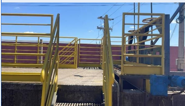
Guarda-corpo para cumprimento da NR12 em visita no dia 31/10/2024
