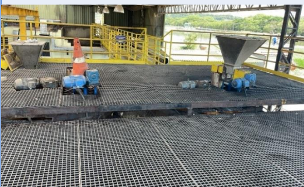
Guarda-corpo para cumprimento da NR12 em visita no dia 31/10/2024
