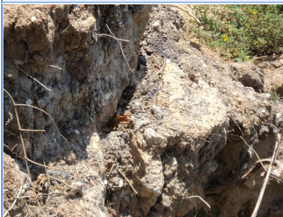
Erosão da margem esquerda do Rio Jundiáí Fonte: Imagem fornecida pela CSJ
