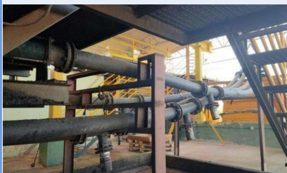
Condução do lodo por meio de tubulações em PEAD Fonte: Fornecido pela CSJ
