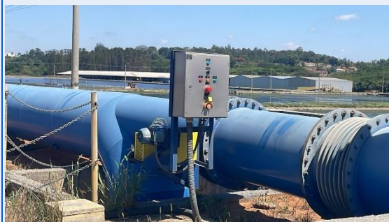
Proteção de parte móvel e elétrica para cumprimento da NR12 em visita no dia 31/10/2024
