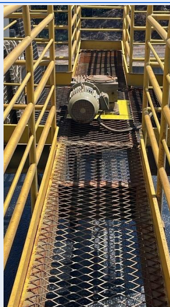
Guarda-corpo para cumprimento da NR12 em visita no dia 31/10/2024
