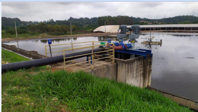
Posição das bombas instaladas para o retorno do lodo Fonte: Fornecido pela CSJ
