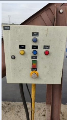
Proteção elétrica das rosas parafuso para cumprimento da NR12 Fonte: Fornecido pela CSJ
