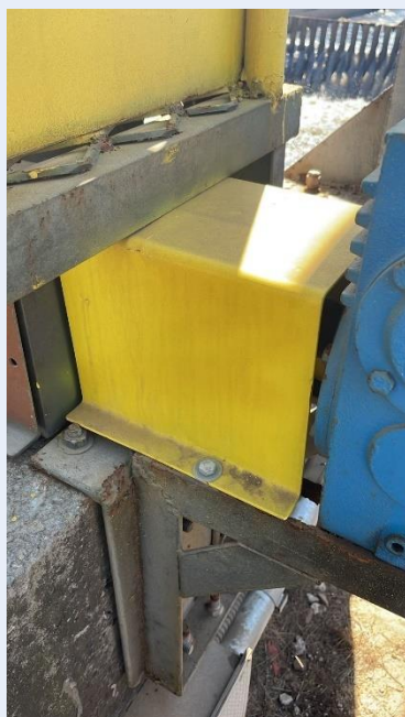
Proteção de parte móvel para cumprimento da NR12 em visita no dia 31/10/2024
