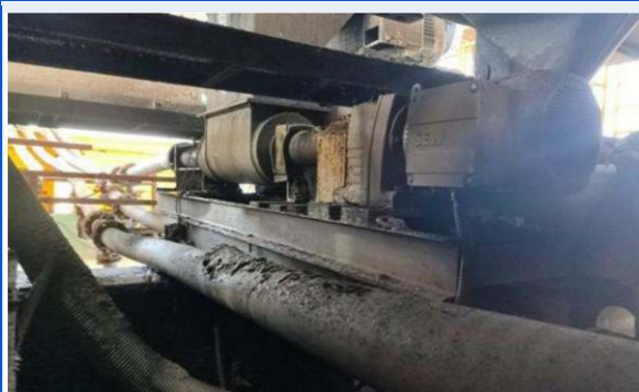
Substituição das esteiras por bombas de deslocamento positivo Fonte: Fornecido pela CSJ
