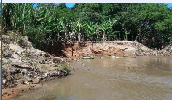
Erosão da margem esquerda do Rio Jundiáí Fonte: Imagem fornecida pela CSJ
