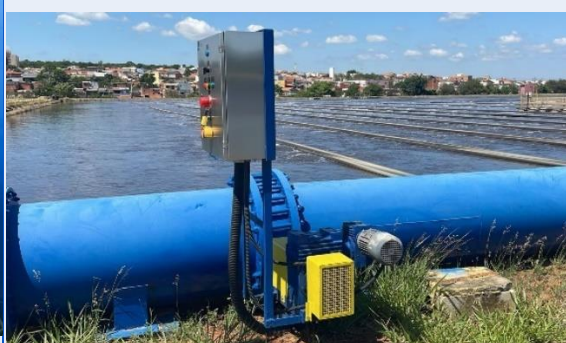
Proteção de parte móvel e elétrica para cumprimento da NR12 em visita no dia 31/10/2024
