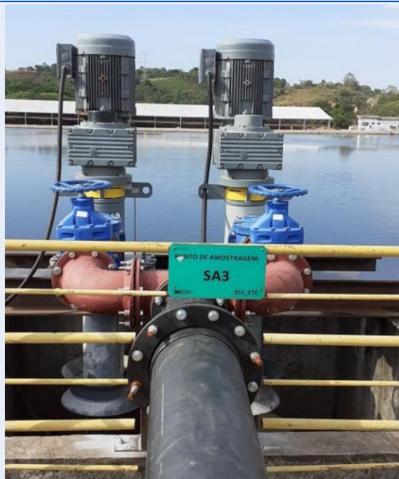
Bombas de Retorno de Lodo para Lagoa de Aeração Fonte: Fornecido pela CSJ
