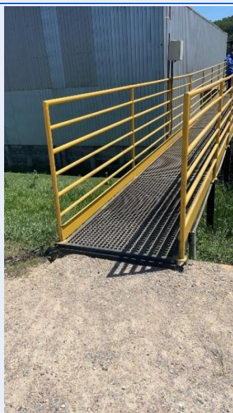
Guarda-corpo para cumprimento da NR12 em visita no dia 31/10/2024
