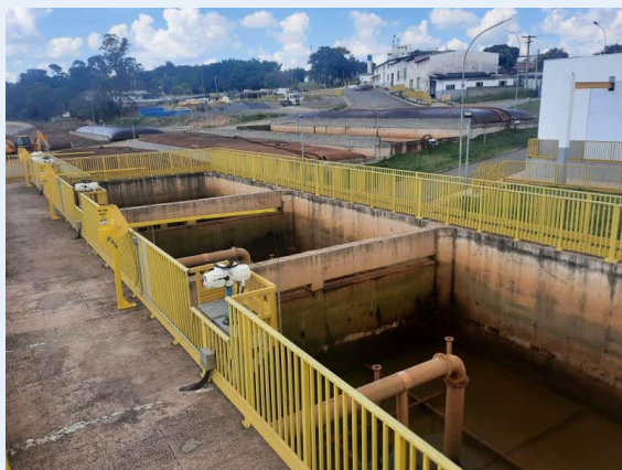
Figura 10: Tanques de adensamento
