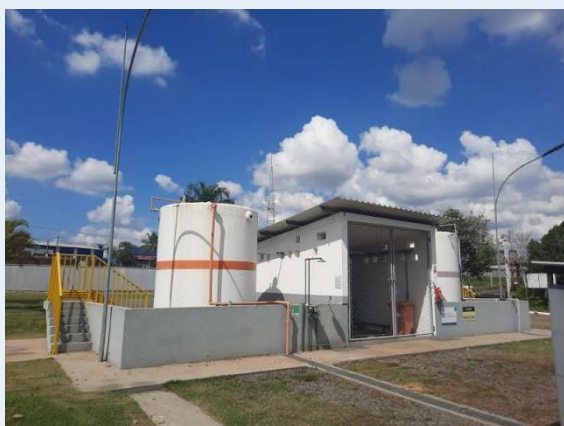
Figura 14: Sistema de geração de Dióxido de Cloro
