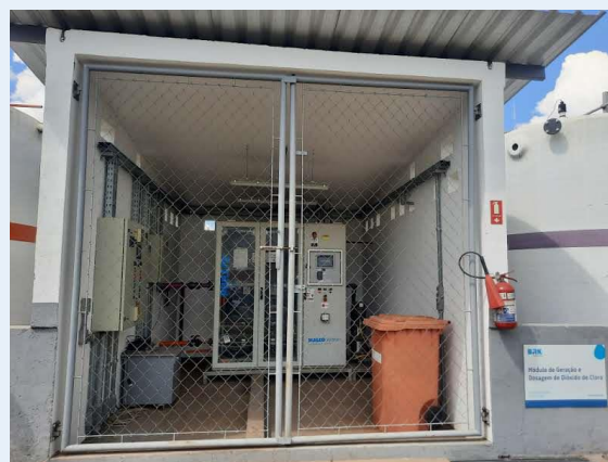
Figura 15: Gerador de Dióxido de Cloro
