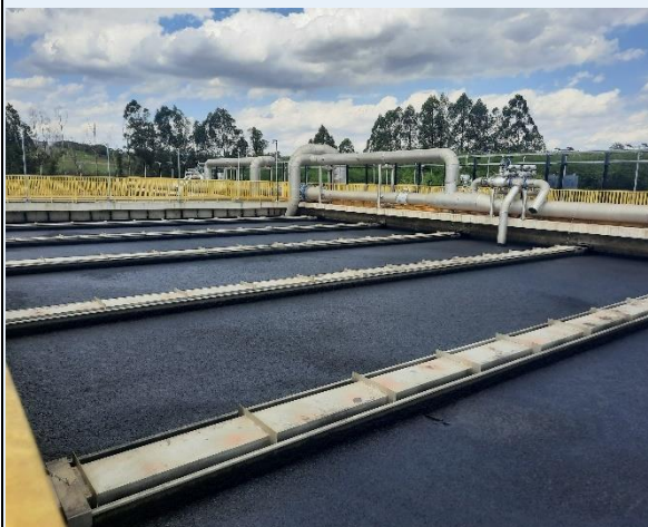
Figura 23: Vista superior do sistema de tratamento Nereda
