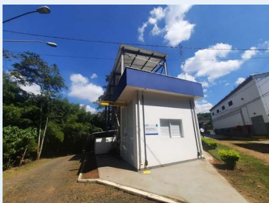
Figura 1: Sistema de dosagem de hipoclorito de sódio
