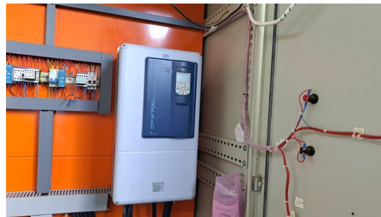
Foto 2 – Inversor de frequência do conjunto motobomba nº 2 da EEAT Uma, dentro da ETA Rancho Grande.
