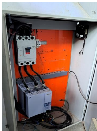
Foto 1 – Soft-starter instalado na EEAT São Camilo, dentro da ETA Rancho Grande.
