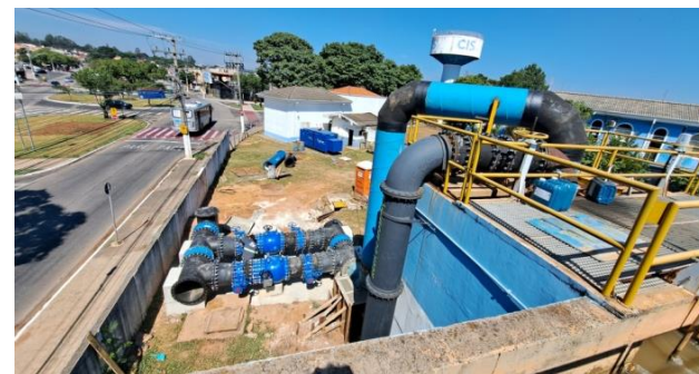
Foto 4 – Barrilete da chegada da adutora da Captação Utu-Guaçu na ETA Rancho Grande.
