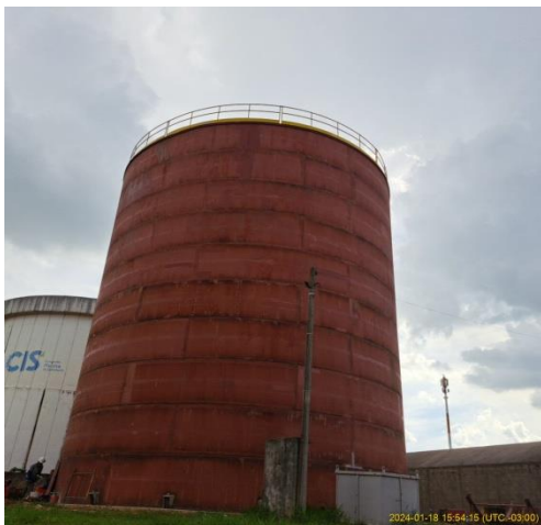
Foto 1 – Novo reservatório do CR Terras de São José.
