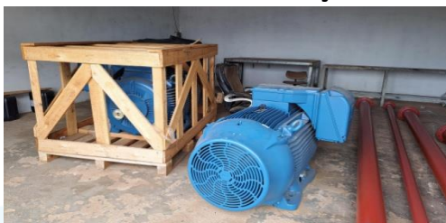
Foto 1 – Motores (450 cv) da EEAB Pau D’Alho, em estoque na CIS.
