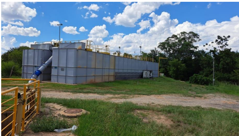
Foto 1 – Módulos da ETA Itaim.
