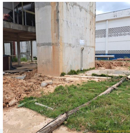
Foto 4 – Vista da caixa de entrada da ETE Pirajibu em obras para reabilitação estrutural.
