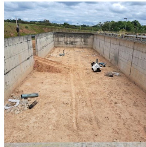
Foto 2 – Primeiro módulo de tratamento da ETE Pirajibu em obras para reabilitação estrutural.
