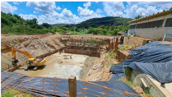
Foto 1 – Construção da fundação e estrutura das caixas desarenadoras e do abrigo dos conjuntos motobomba de recalque de água bruta.
