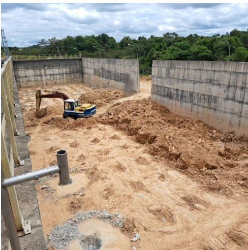
Foto 3 – Segundo módulo de tratamento da ETE Pirajibu em obras para reabilitação estrutural.
