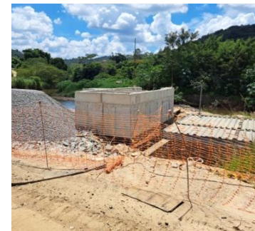
Foto 2 – Estrutura de entrada da água bruta oriunda do Ribeirão Guaçu para as caixas desarenadoras.
