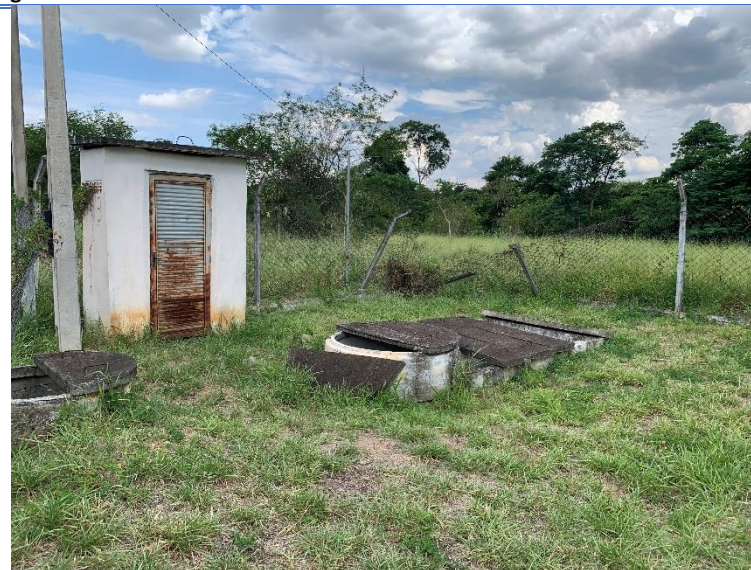
Figura 45 - EEE 2 DIC 1. Não operante.
