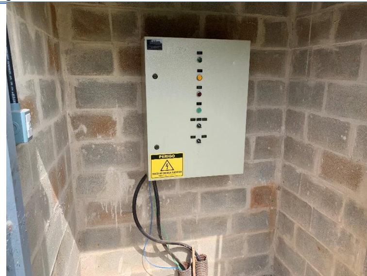
Figura 25 - Novo painel elétrico do poço Pagotto.
