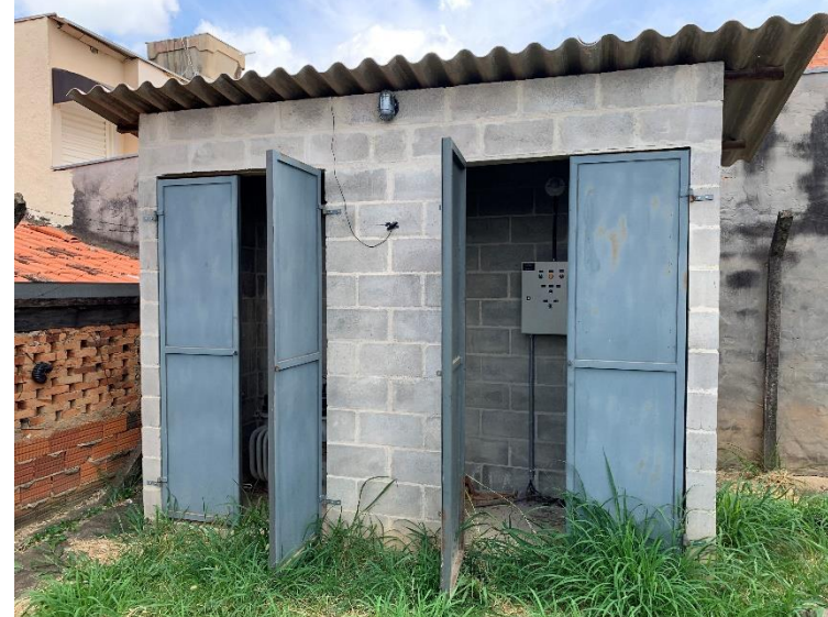
Figura 29 - Abrigo do painel elétrico.
