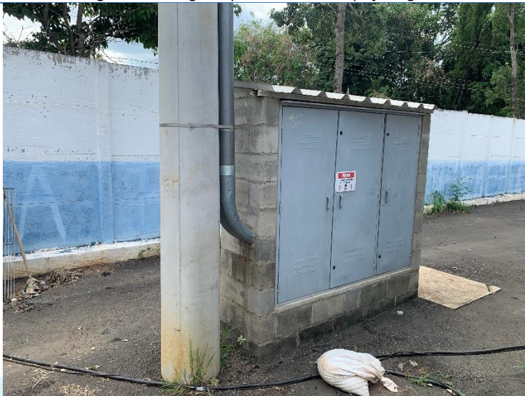
Figura 26 - Abrigo para entrada de energia da ETA 1.
