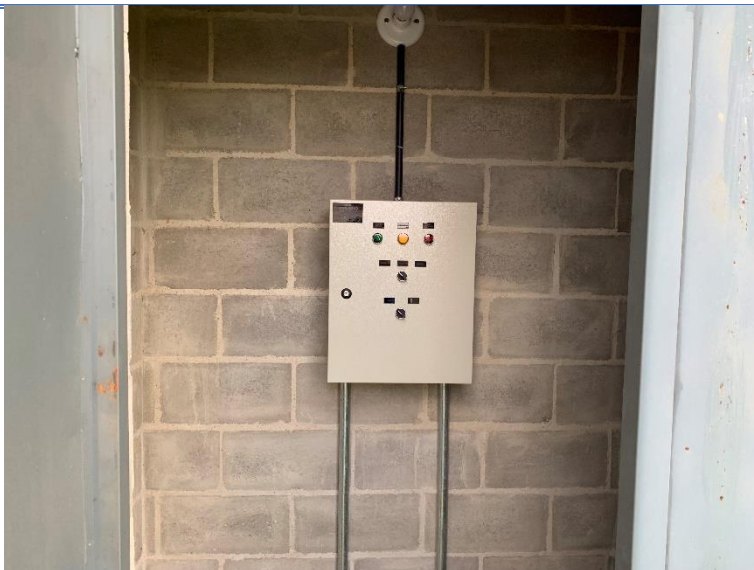
Figura 28 - Novo painel elétrico do poço Jardim do Bosque Anexo.
