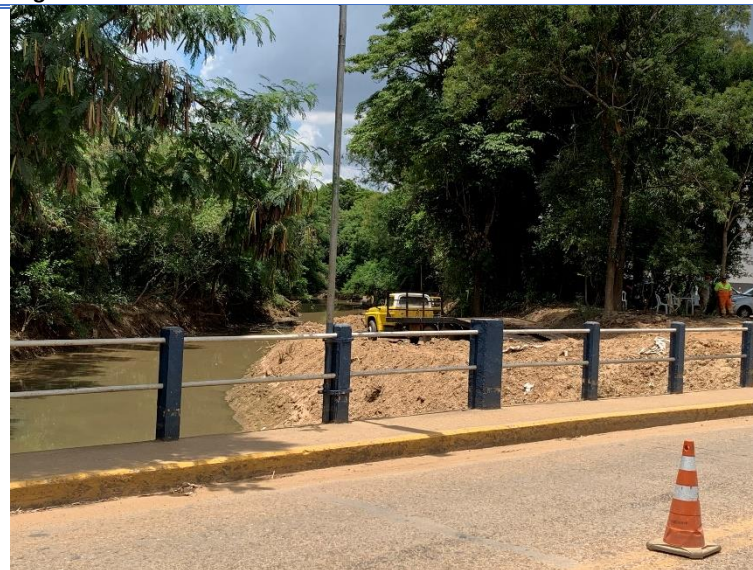
Figura 17 - Local de instalação de uma das quatro EEs do sistema.
