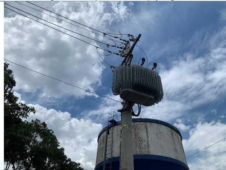
Figura 27 - Transformador da entrada de energia da ETA 1.
