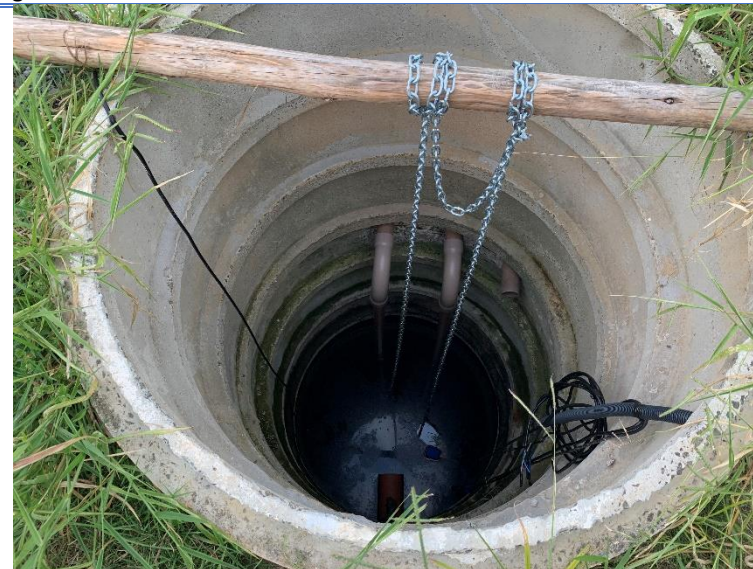
Figura 49 - EEE 4 DIC 1. Em operação.
