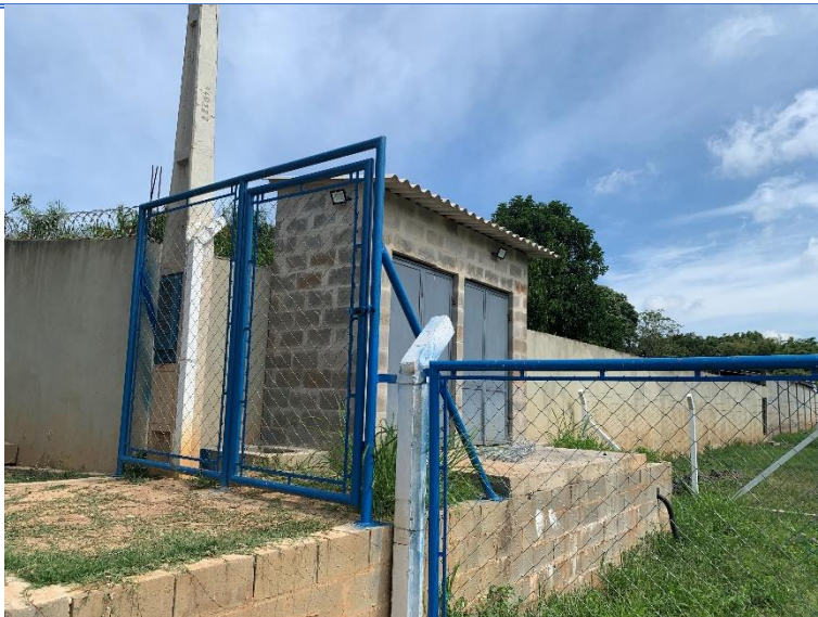
Figura 24 - Abrigo do painel elétrico do poço Pagotto.
