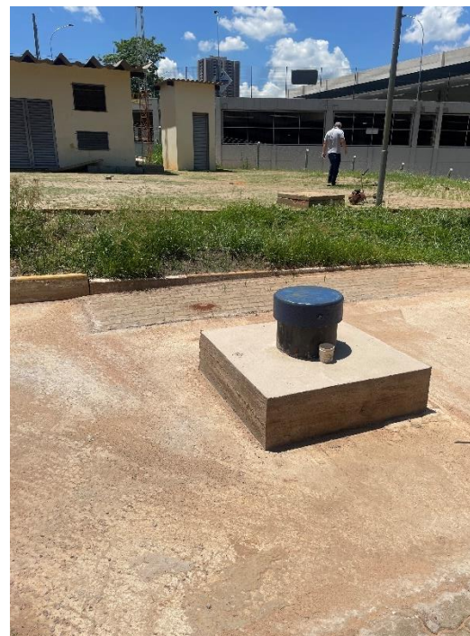
Foto 2 – Poço Tubular Profundo – Cruzes II.
