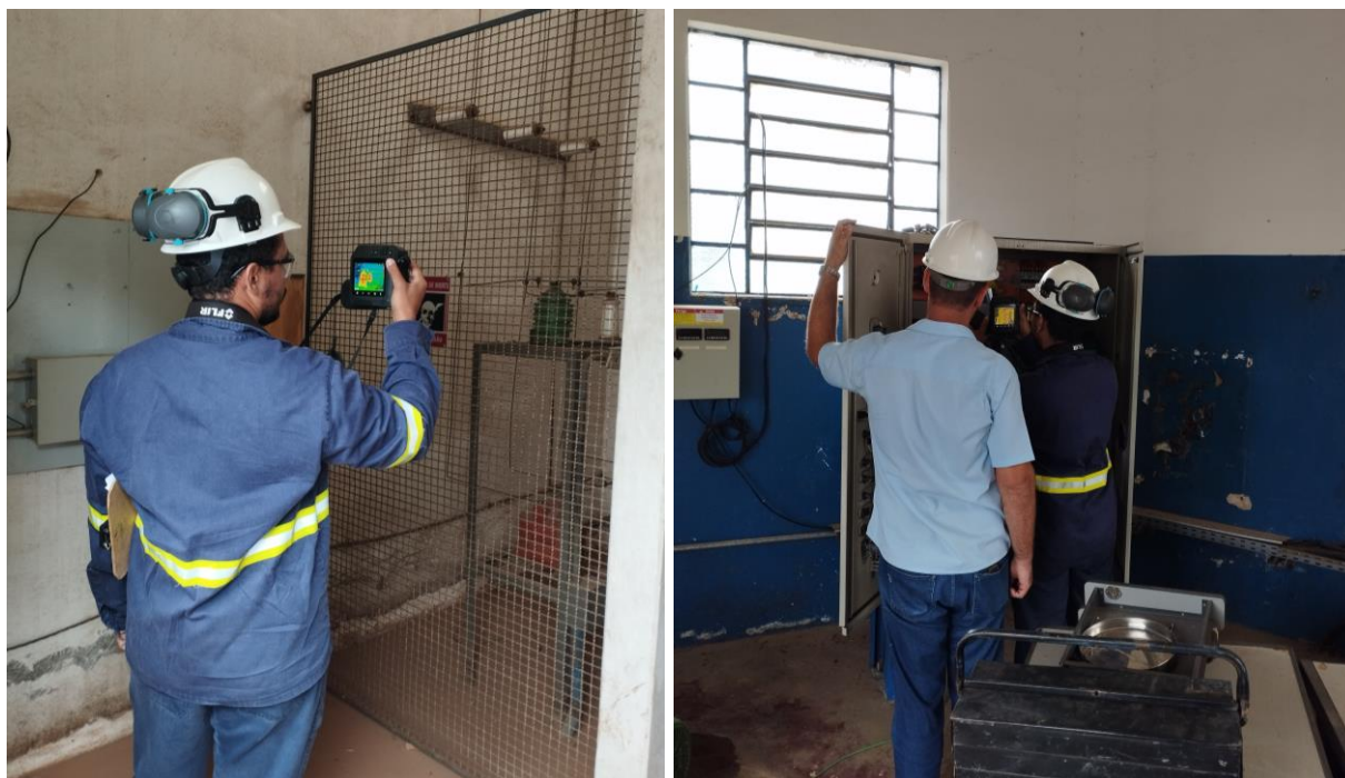
Figura 2. Inspeção termográfica em equipamentos elétricos.
