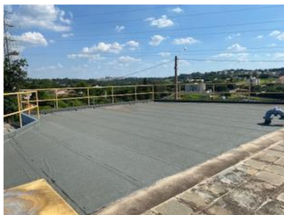
Figura TTEC 2 – Aplicação de manta asfáltica sob a casa de bombas da ETA I
