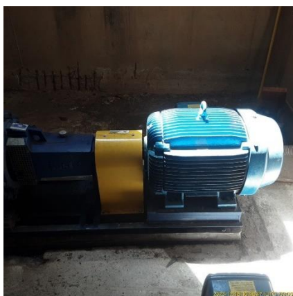
Figura TEC 12 – Bomba Centrífuga da EEE Prainha (elevatória de esgoto)
