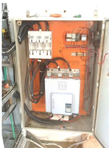
Figura TEC 11 – Soft Starter instalado na EEAB São Joaquim (Fonte: SANEBAVI)
