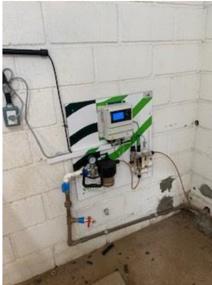
Figura TEC 3 – Analisador contínuo de controle de parâmetros, instalado no Santa Fé
