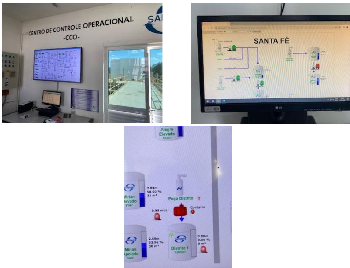
Figura TEC 7 – Painel e janelas da automação, controle e gerenciamento dos poços artesianos
